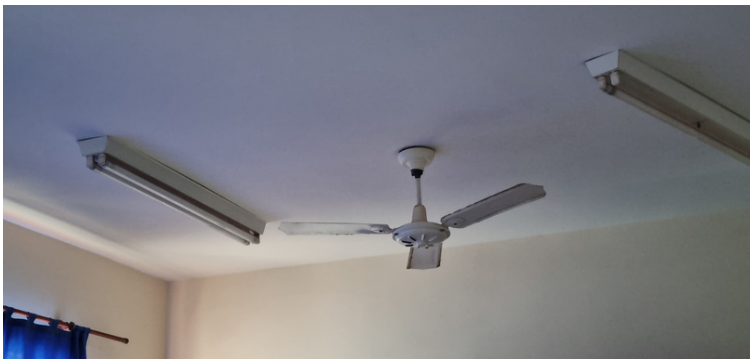
Foto 3 - Ventiladores instalados nas salas de aula não desempenham ideal climatização.
