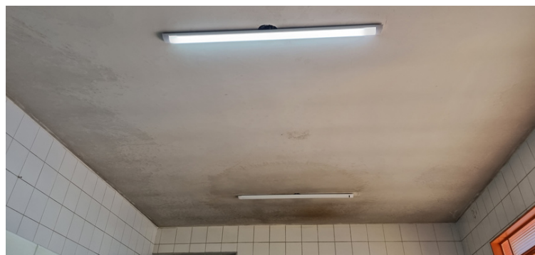
Foto 8 - Infiltração constante em locais pontuais da unidade.
