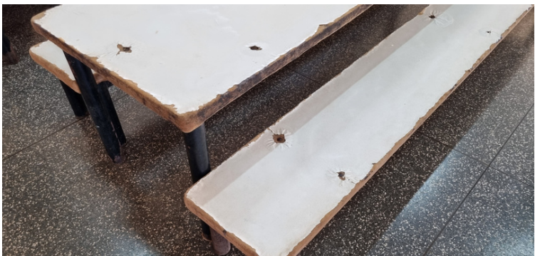
Foto 5 - Refeitório da instituição necessitando de novo mobiliário.
