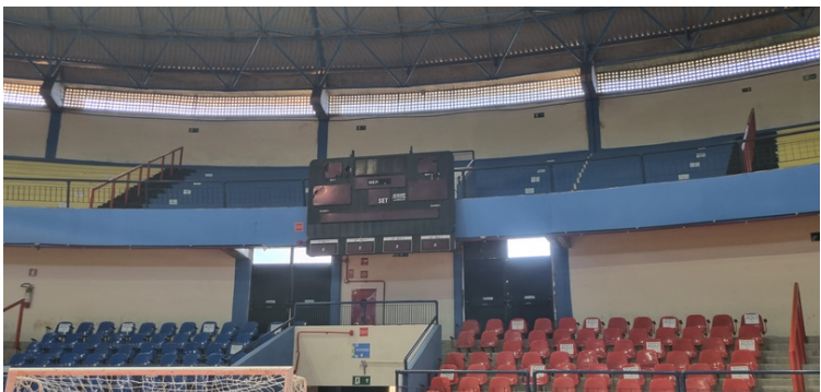
Foto 5 Placar eletrônico não está funcionando.
