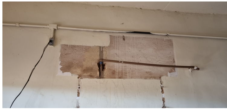
Foto 2 Falta de acabamento na parede no corredor de entrada do setor 1.
