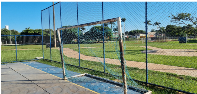
Foto 6 Traves enferrujadas e com a estrutura torta.
