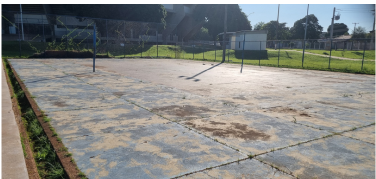
Foto 7 Pintura das quadras na parte externa danificada.
