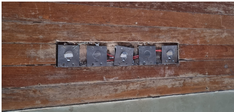
Foto 4 Fiação exposta no área da quadra.
