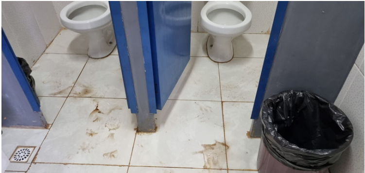
Foto 11 Banheiro recém reformado com vazamentos.
