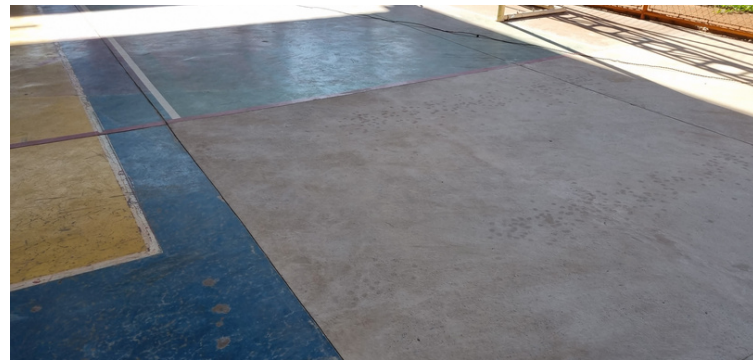
Foto 2 Falta pintura na parte da quadra de esportes que foi reformada.
