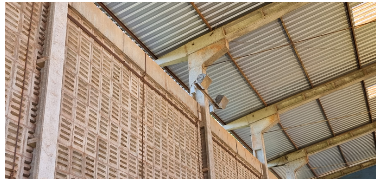
Foto 4 Refeltores não estão funcionando por conta de furto da fiação elétrica na quadra.
