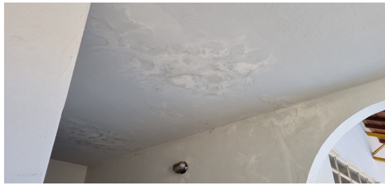
Foto 10 Infiltração na laje causada por problemas no telhado.
