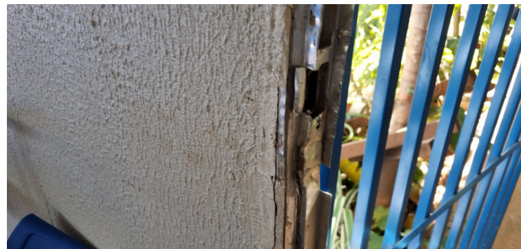
Foto 6 Fechadura do laboratório de ciências danificada por tentativa de arrombamento.
