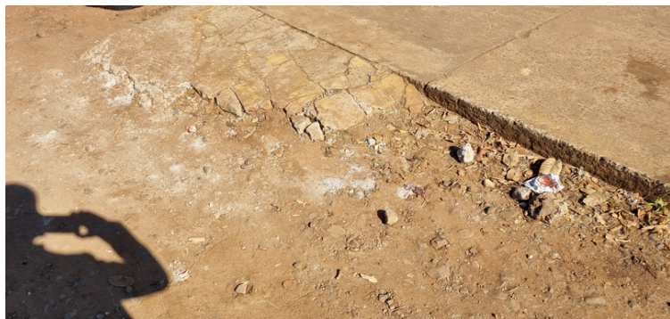
Foto 15 Rampa de acessibilidade danificada.
