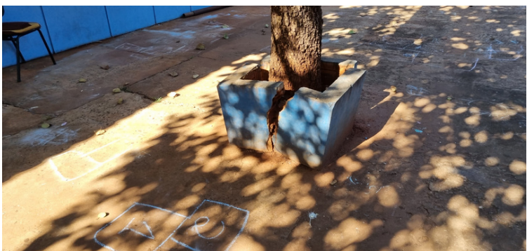
Foto 7 Estrutura que envolve a árvore com rachaduras.
