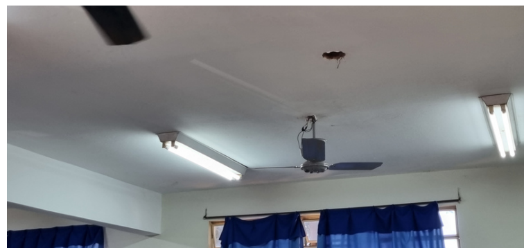
Foto 8 Ventiladores na sala de aula estragados.
