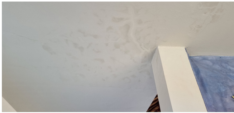
Foto 9 Infiltração na laje.
