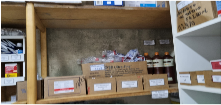
Foto 3 Mofo na parede da farmácia interna.
