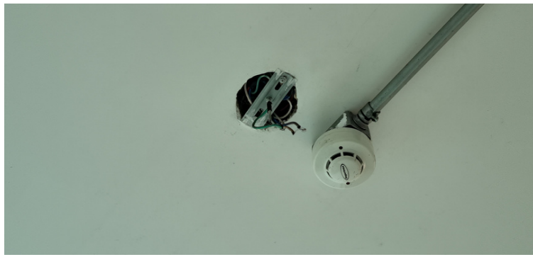
Foto 9 Fiação exposta no teto do corredor.
