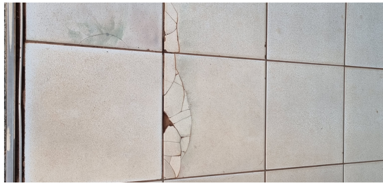
Foto 2 Piso quebrado na entrada da UPA.
