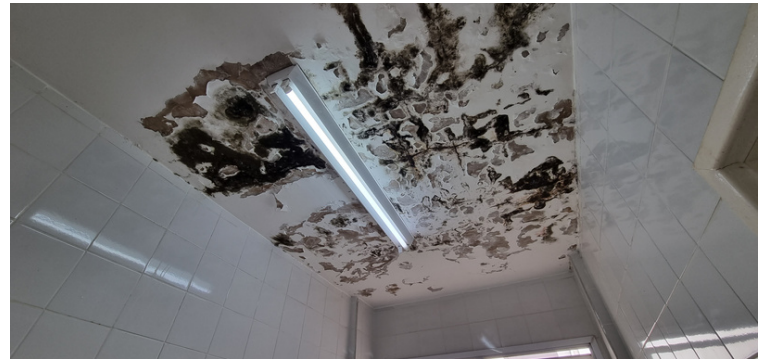
Foto 6 Infiltração com mofo na emergência pediátrica.
