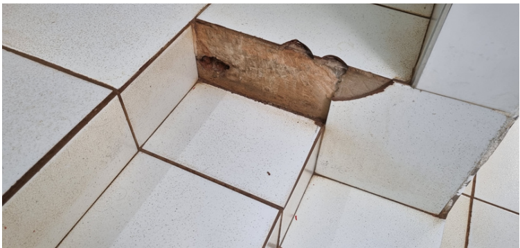
Foto 11 Pisos quebrados na sala de emergência.
