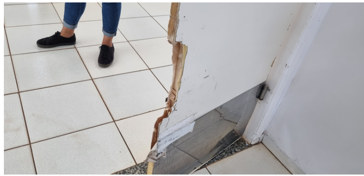
Foto 10 Portas das salas de emergência danificadas.
