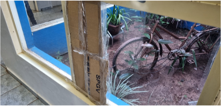
Foto 3 Vidro da janela quebrado.
