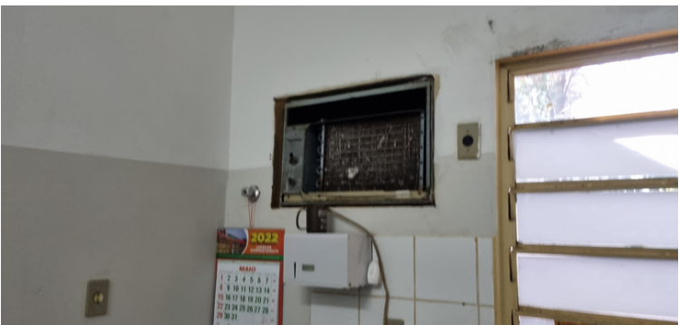
Foto 7 Ar-condicionado do consultório antigo e sem funcionar.
