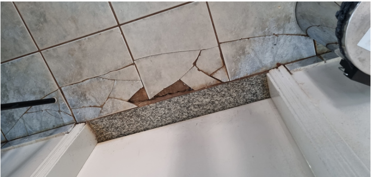
Foto 5 Pisos quebrados na entrada do consultório.
