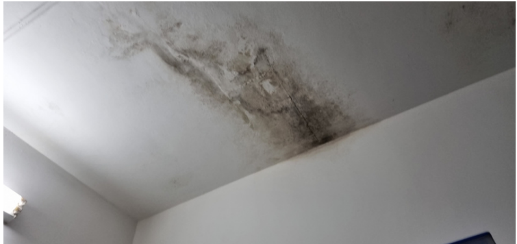
Foto 12 Infiltração com mofo em uma das salas de atendimento.
