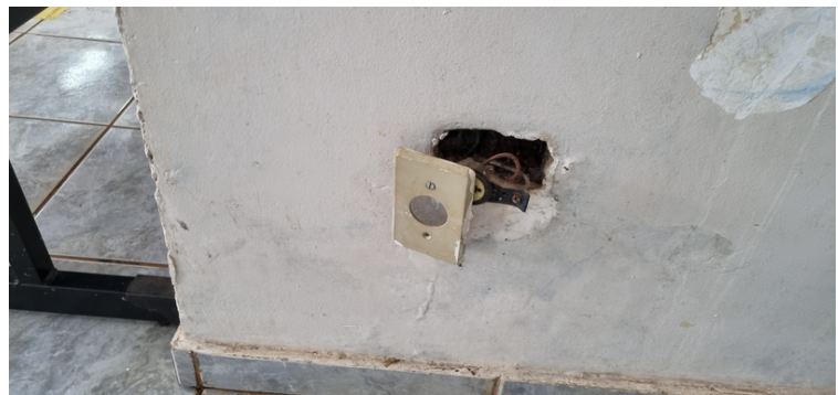
Foto 8 Tomada com fiação exposta na recepção.
