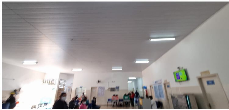
Foto 17 Recepção carente de iluminação.
