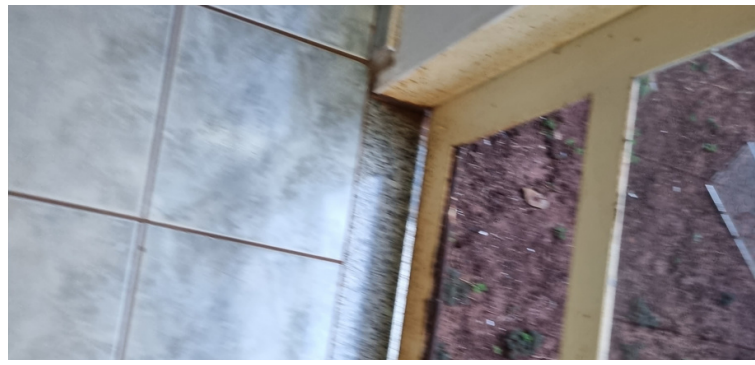
Foto 2 Porta do corredor com o vidro quebrado e com ferrugem.
