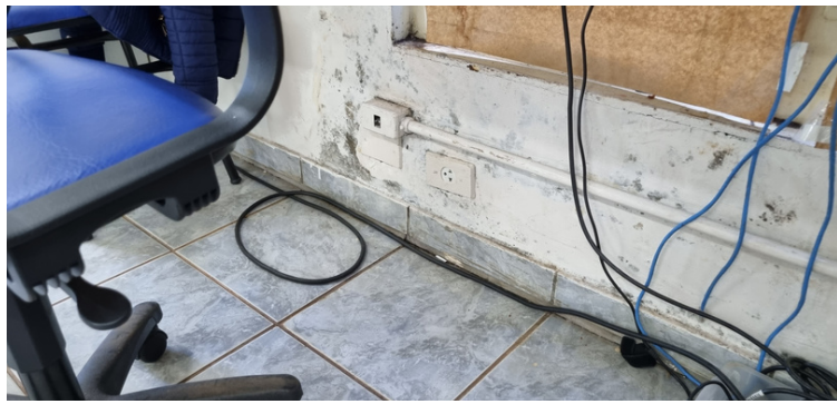
Foto 9 Infiltração na parede da sala de odontologia.
