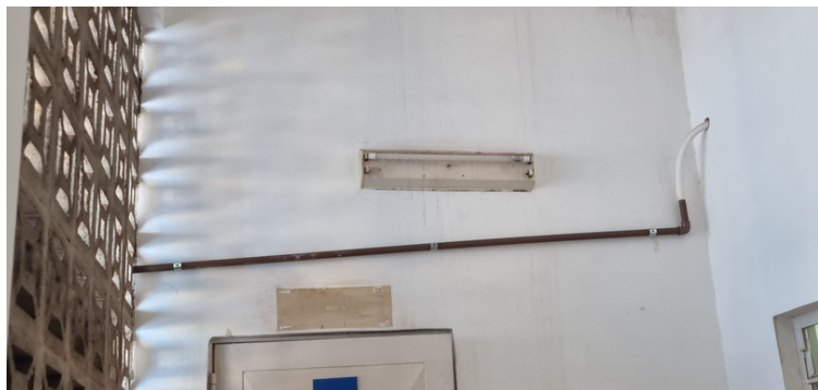
Foto 15 Luminária sem lâmpada na entrada da unidade.
