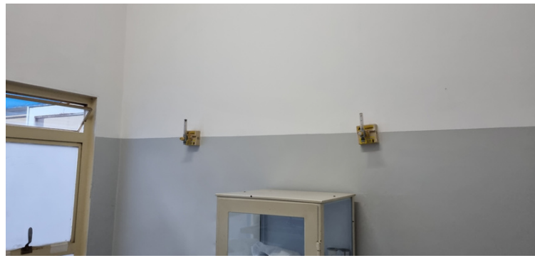
Foto 18 Oxigênio da sala de inalação sem funcionar.
