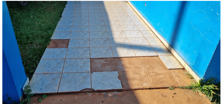
Foto 6 Pisos danificados na entrada da unidade de saúde.
