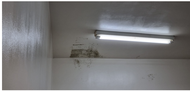
Foto 10 Infiltração com mofo no teto da sala de odontologia.
