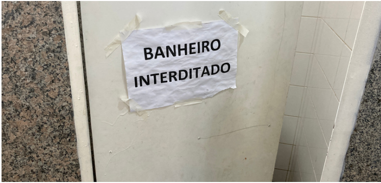
Foto 11 Ausência de manutenção no banheiro destinado aos alunos.
