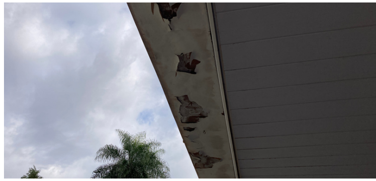
Foto 10 Focos de infiltração pelas dependências da escola.
