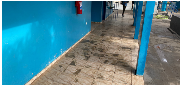
Foto 2 Pisos manchados, trincados ou quebrados.
