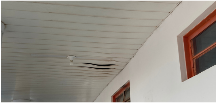
Foto 3 Forro deteriorado, resultado de infiltração.
