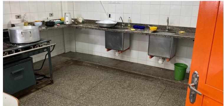
Foto 6 Necessidade da instalação de armários na cozinha.
