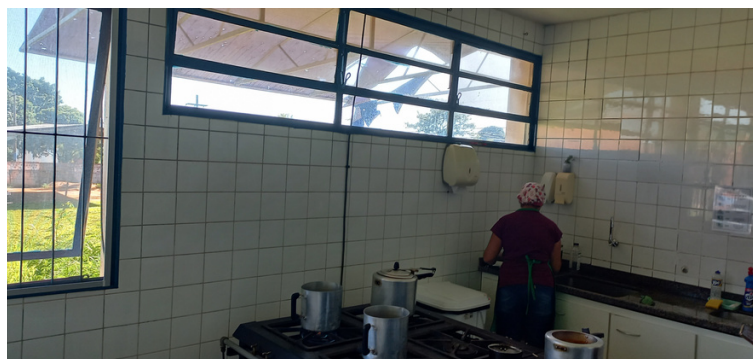
Foto 6 Cozinha com toldo danificado e panelas quebradas.
