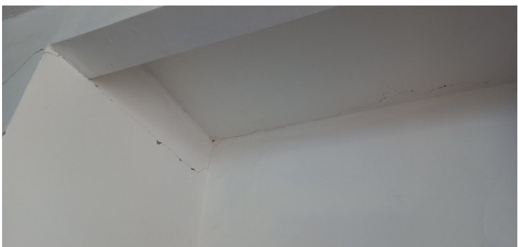
Foto 5 Rachaduras na parede do banheiro feminino.
