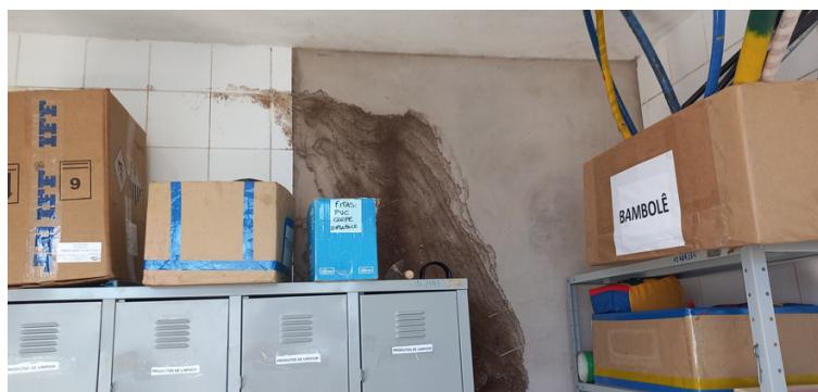
Foto 4 Lavanderia com as paredes sem pintura.
