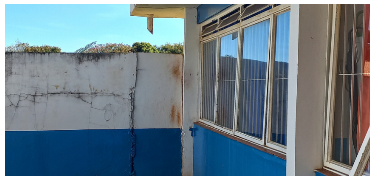
Foto 8 Rachaduras no muro do parque infantil.
