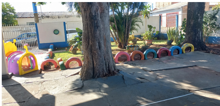
Foto 2 Raízes da árvore danificou a calçada.
