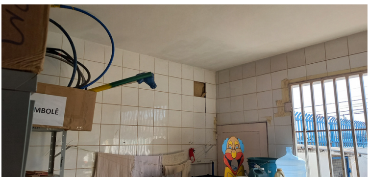
Foto 3 Lavanderia com azulejos soltos na parede.
