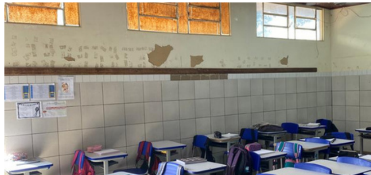
Foto 6 Salas de aulas devidamente mobiliadas e climatizadas, entretanto com a pintura desgastada.
