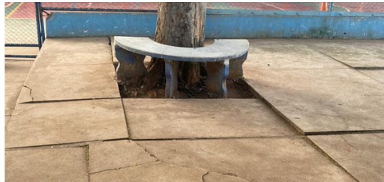
Foto 4 Raízes de árvores comprometendo a estrutura dos pisos.
