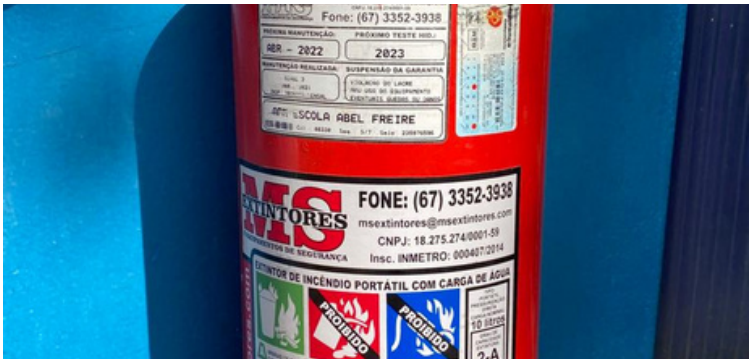
Foto 3 Extintores com a data de validade expirada.
