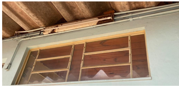
Foto 2 Luminárias corroídas pela ferrugem comprometendo a rede elétrica.
