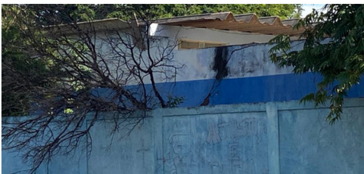
Foto 7 Estrutura frontal da unidade repleta de rachaduras, bem como árvore caída sobre o muro, sem o devido descarte.
