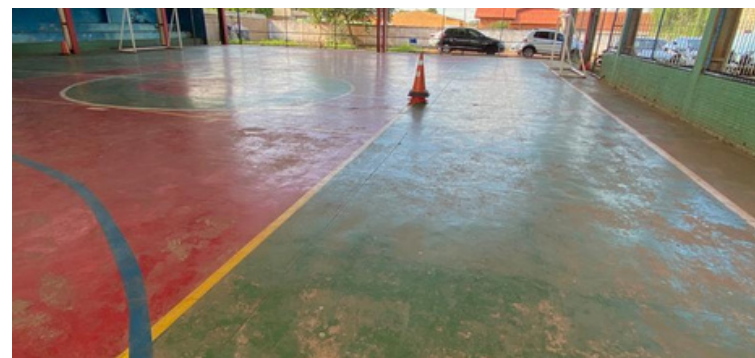
Foto 8 Quadra esportiva necessitando de revitalização na pintura.
