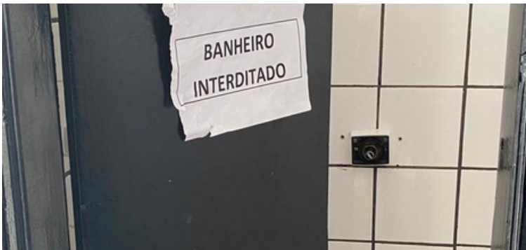
Foto 5 Banheiro interditado devido à ausência de manutenção.
