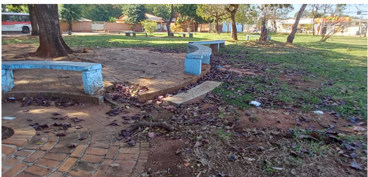
Foto 3 Calçadas com pisos danificados.
