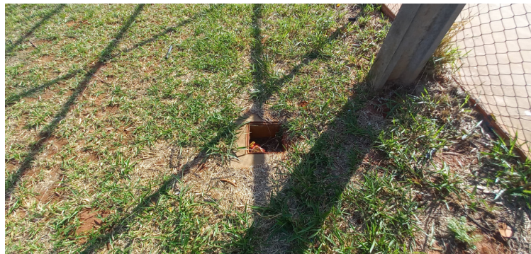
Foto 6 Caixas de passagem sem tampas, possibilitando ocorrência de acidentes.
