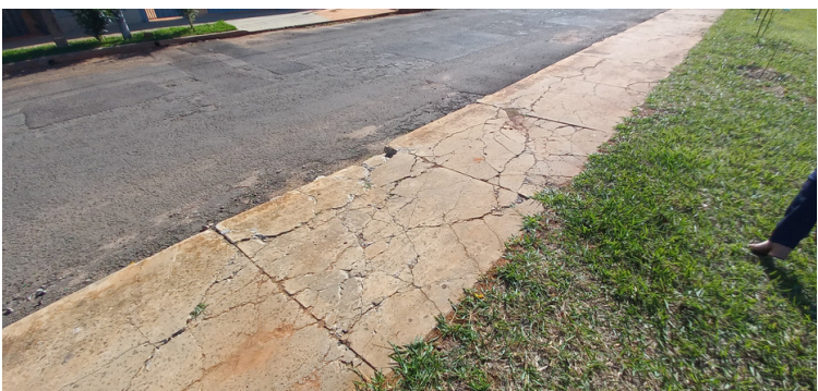
Foto 5 Calçada entorno da praça repleta de rachaduras e buracos.
