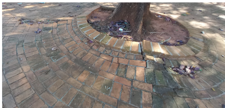
Foto 4 Raízes comprometendo a estrutura da calçada.
