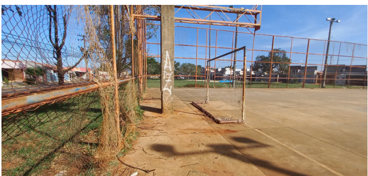
Foto 7 Quadra esportiva com telas avariadas e pintura consideravelmente desgastada.
