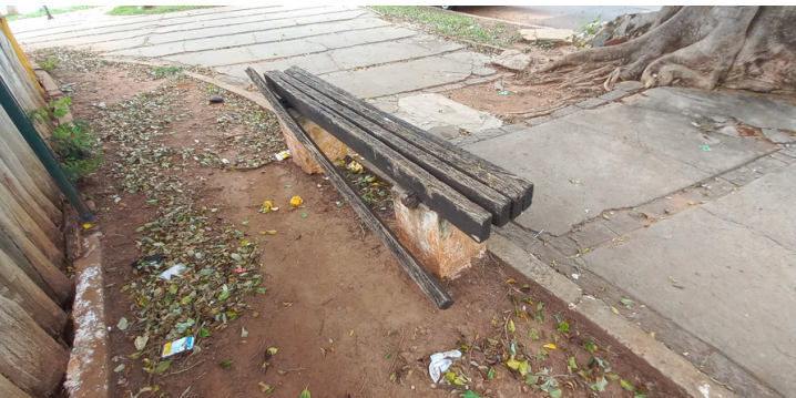
Foto 5 Bancos de madeira encontram-se avariados.
