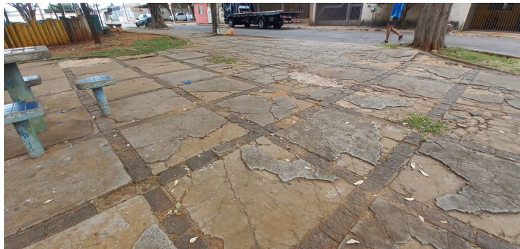
Foto 3 Calçamento quebrado e despedaçado.
