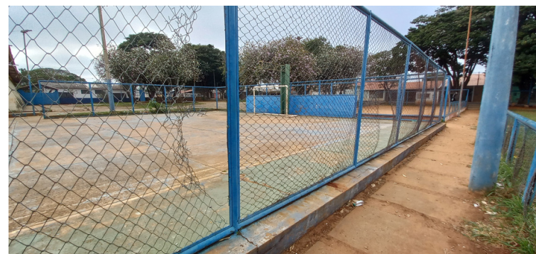
Foto 8 Quadra de esportes precisando de revitalização na pintura e conserto no alambrado.
