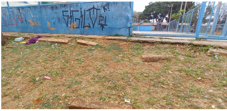
Foto 9 Parte posterior da praça vandalizada e com a estrutura da calçada danificada.
