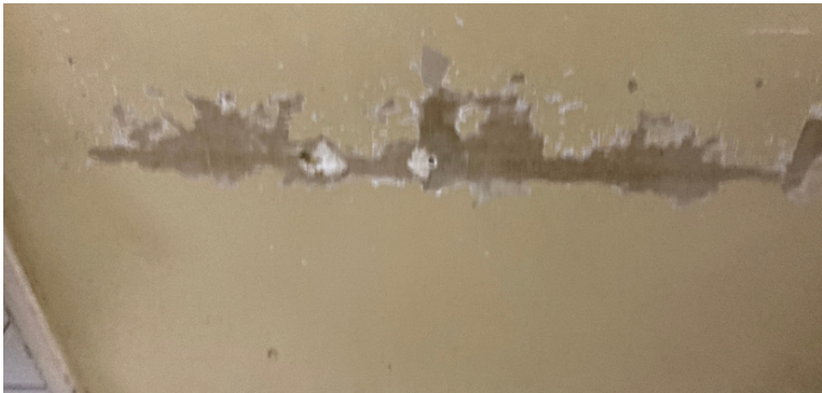
Foto 5 Pintura da parede do corredor danificada.
