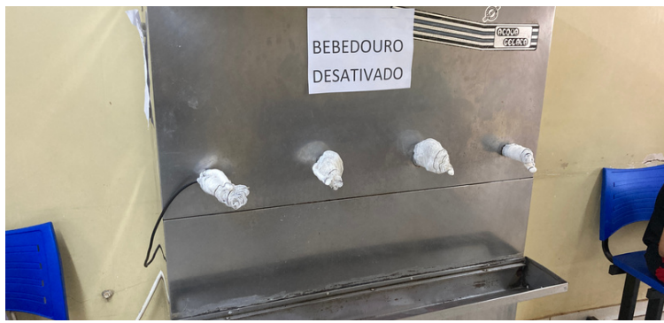
Foto 9 Bebedouro desativado por falta de manutenção.
