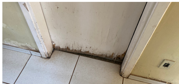
Foto 8 Porta antiga e danificada.
