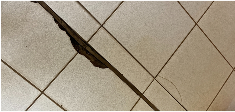
Foto 11 Piso quebrado no corredor.
