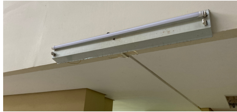
Foto 12 Falta de lâmpadas nas luminárias do corredor.
