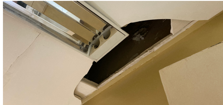
Foto 6 Estrutura do forro de gesso quebrada.
