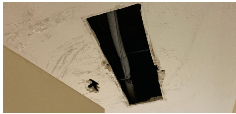
Foto 2 Forro de gesso com abertura no teto do corredor.
