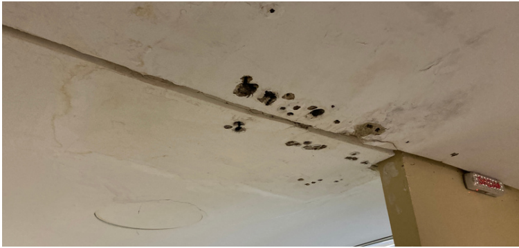
Foto 3 Infiltração com a presença de mofo nas salas de espera.
