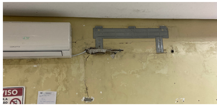
Foto 10 Infiltração na parede da sala de gesso por conta de vazamento no ar-condicionado.
