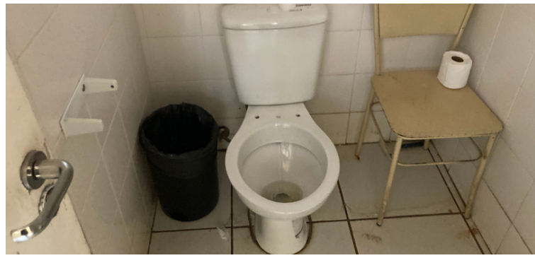
Foto 18 Banheiro pequeno e sem equipamentos de acessibilidade.
