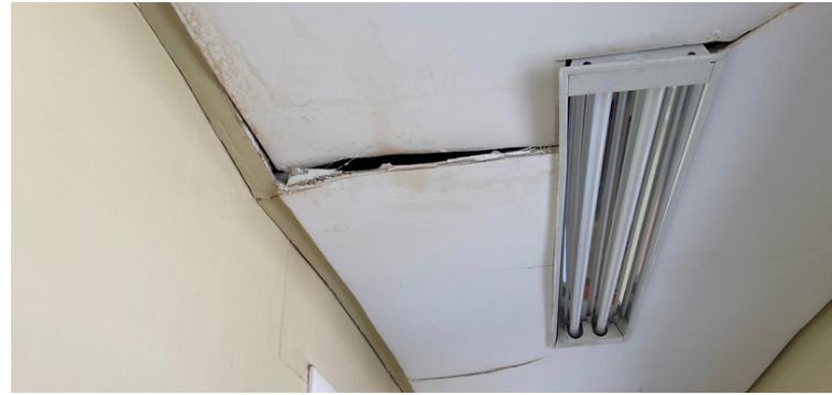
Foto 4 Forro de gesso rachado.
