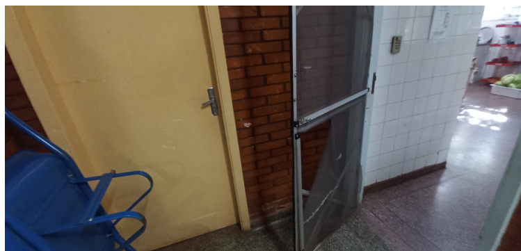
Foto 4 Porta telada instalada na área da cozinha encontra-se danificada.
