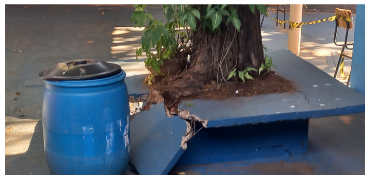
Foto 8 Canteiro de concreto quebrado suscetível à ocorrência de acidentes.
