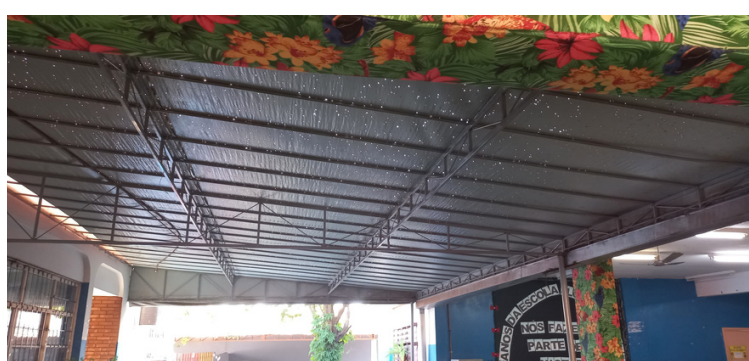
Foto 6 Toldo encontra-se avariado.
