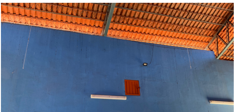
Foto 13 Infestação de pombos na escola, arruinando a pintura e vetor de transmissão de doenças.
