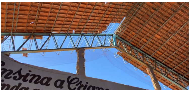
Foto 11 Estrutura significativamente danificada devido a um temporal.
