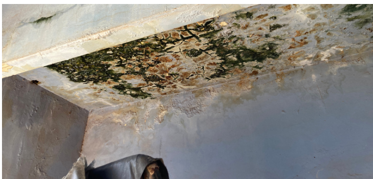
Foto 12 Intensas infiltrações, mofo e lodo sobre banheiro que encontra-se interdito.
