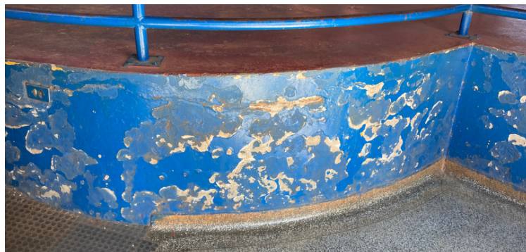
Foto 10 Pintura desgastada por toda a extensão da instituição.
