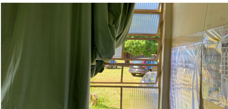
Foto 5 Janelas quebradas por atos de vandalismo.
