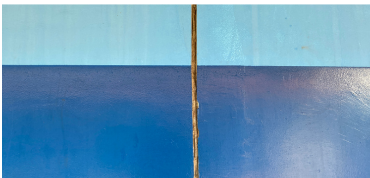
Foto 14 Vasta rachadura comprometendo a estrutura da escola.
