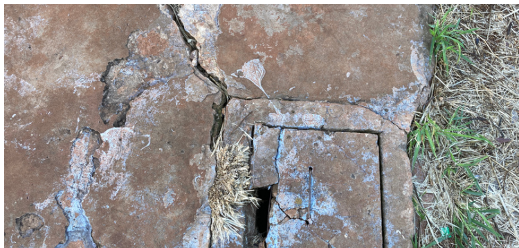
Foto 9 Tampa de esgoto avariada.
