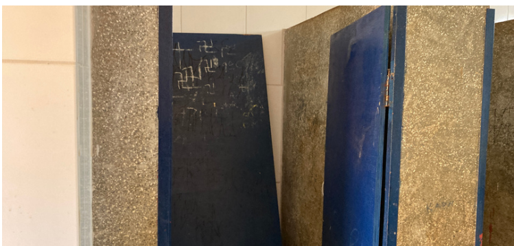
Foto 3 Sanitários com portas quebradas.
