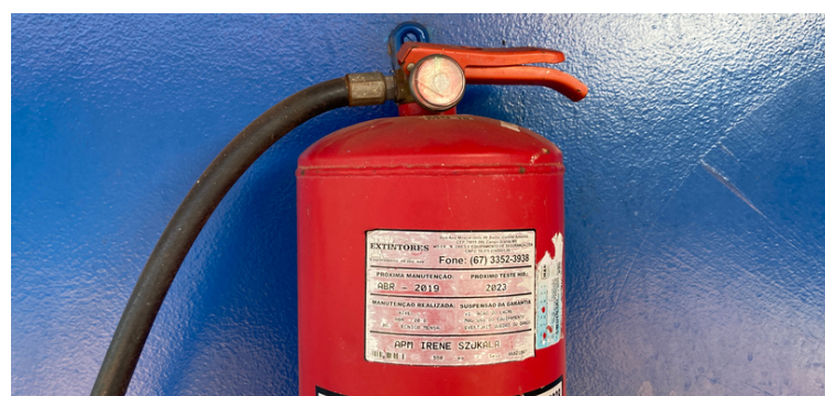
Foto 8 Extintores com a data de validade expirada.
