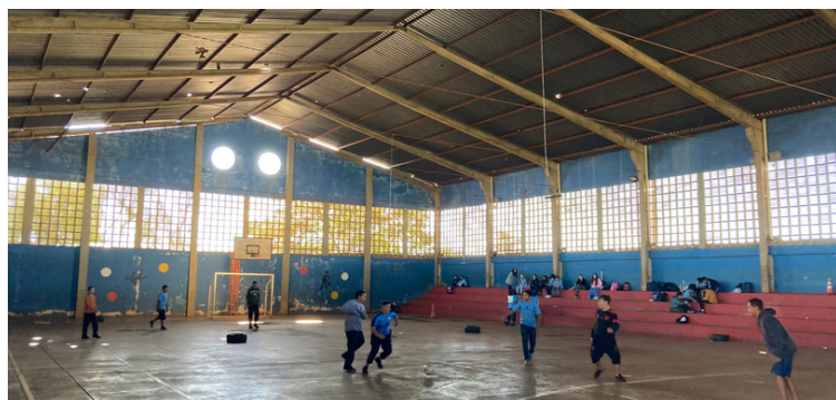
Foto 4 Quadra esportiva sem iluminação devido ao furto da fiação elétrica.
