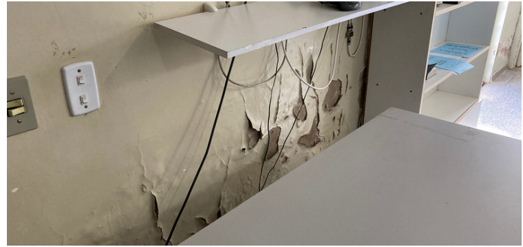
Foto 4 Pintura deteriorada em determinados locais da unidade.
