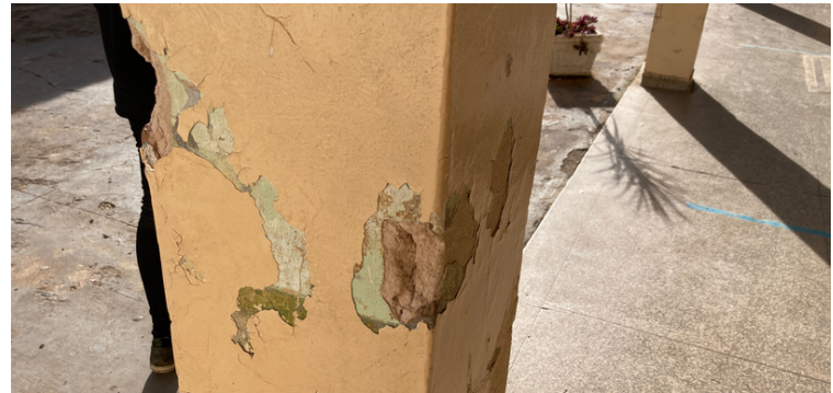
Foto 6 Estruturas comprometidas por extensas rachaduras.
