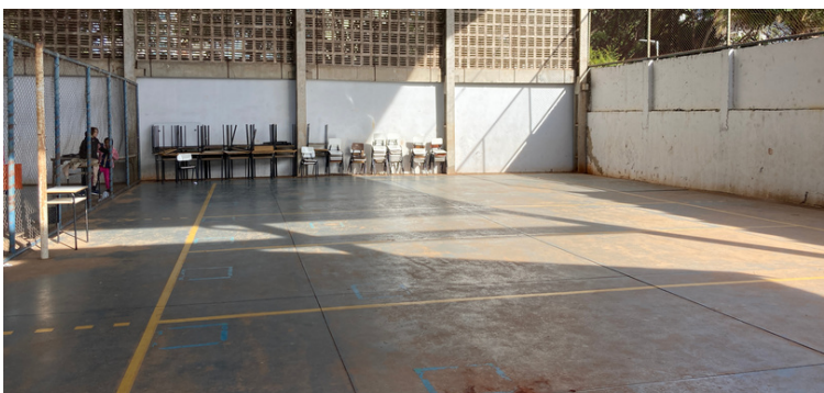
Foto 7 Quadra esportiva necessitando de urgente reforma e revitalização da pintura.
