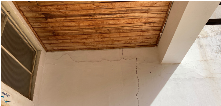
Foto 5 Infiltrações e fissuras por toda a extensão da instituição.
