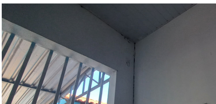
Foto 4 Forro indevidamente impermeabilizado, acarretando vazamento de água dentro da unidade.
