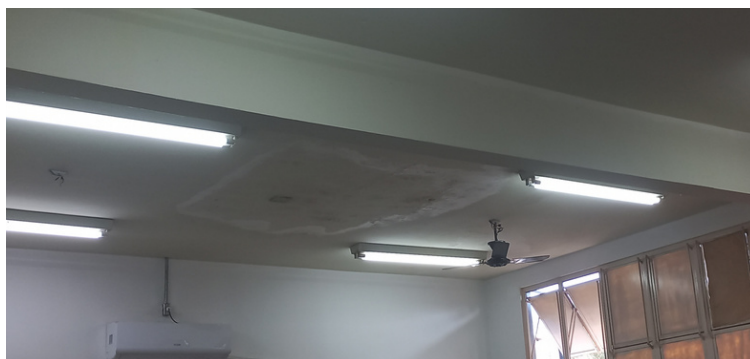
Foto 3 Focos de infiltração em locais pontuais da escola.
