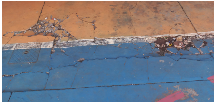
Foto 10 Piso da quadra esportiva com vastos buracos e extensas rachaduras.
