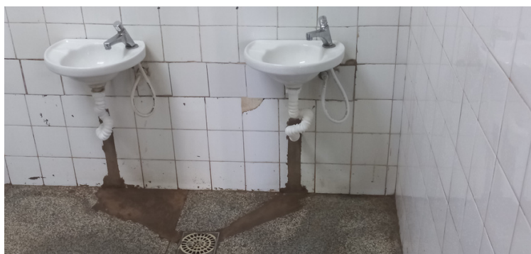
Foto 8 Banheiros necessitando de manutenção.
