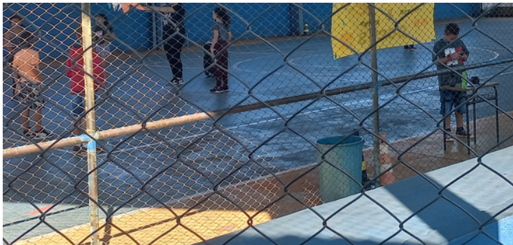
Foto 9 Quadra de esporte com a pintura desgastada.
