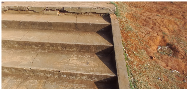
Foto 9 Calçamento, em locais pontuais, encontra-se irregular devido à extensas rachaduras e ocorrência de buracos.
