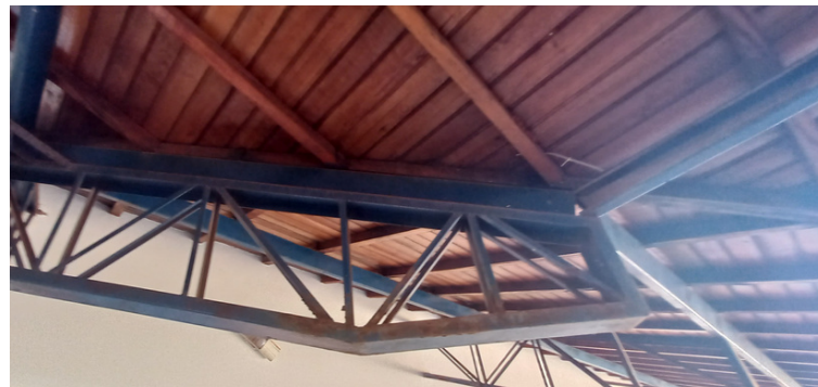
Foto 6 Estrutura de metal da cobertura enferrujada.
