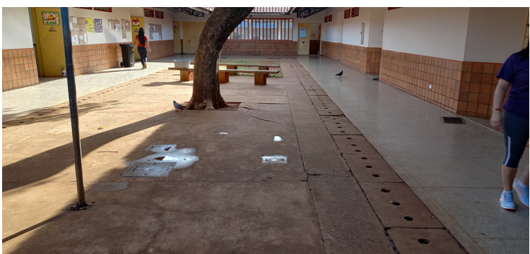
Foto 15 Considerável presença de pombos na instituição.
