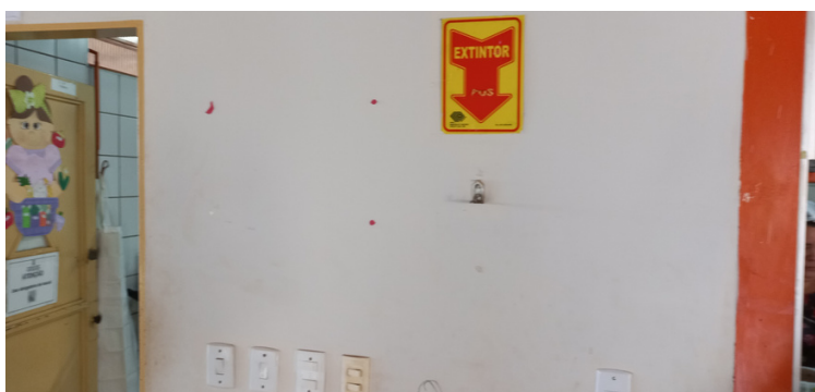
Foto 16 Inexistência de extintores por toda a extensão da escola.
