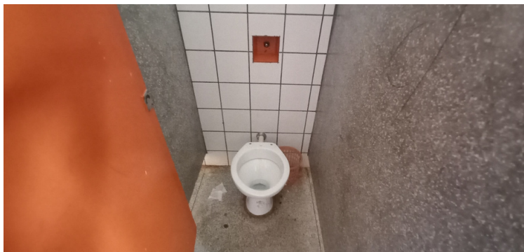
Foto 10 Banheiro sem manutenção hidráulica e inexistência de tampas e assentos sanitários.
