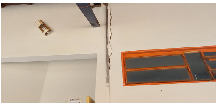
Foto 7 Extensa rachadura ocorrendo em uma das paredes da escola.
