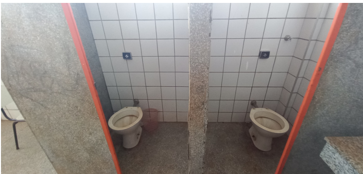
Foto 12 Banheiro da quadra esportiva em condições precárias para uso.
