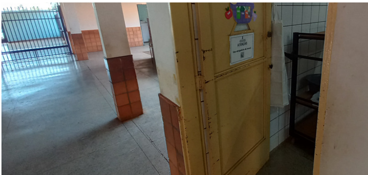
Foto 5 Porta da cozinha corroída por ferrugem, em condições higiênico sanitárias irregulares.
