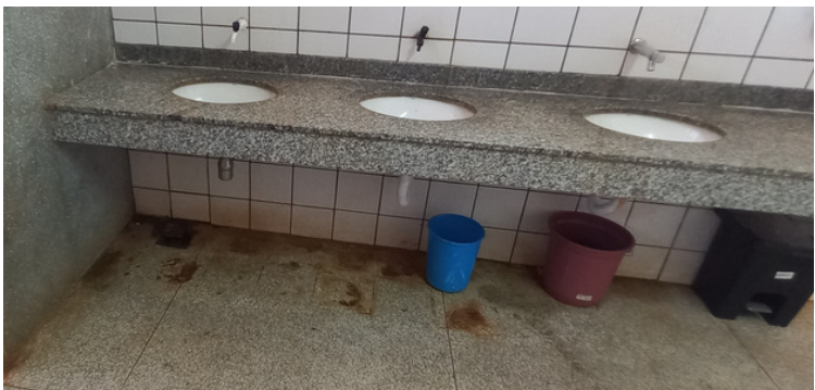
Foto 11 Pisos de determinado banheiro indicando encanamento com vazamento.
