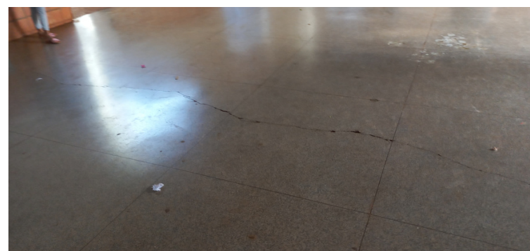
Foto 8 Fissuras e buracos constantes no corredor central da instituição.
