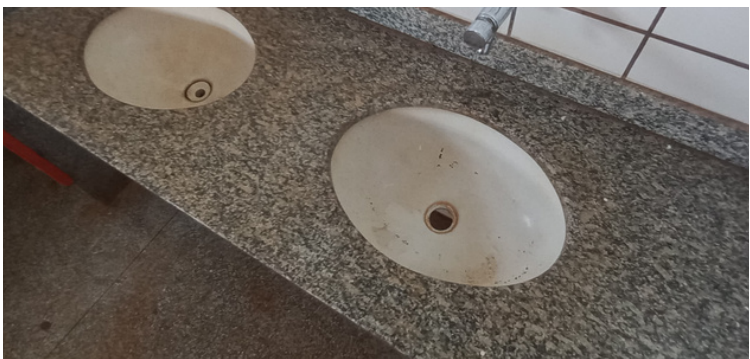
Foto 13 Banheiros na área da quadra, com as pias sem sifões.
