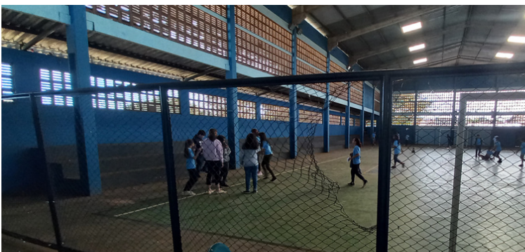
Foto 14 Quadra esportiva com a pintura desgastada, tela de proteção avariada e ausência das tabelas de basquete.
