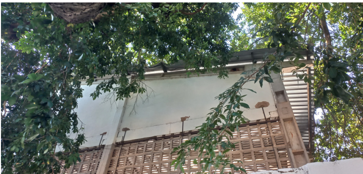
Foto 5 Árvore na parte frontal da unidade prejudicando a estrutura da quadra esportiva.
