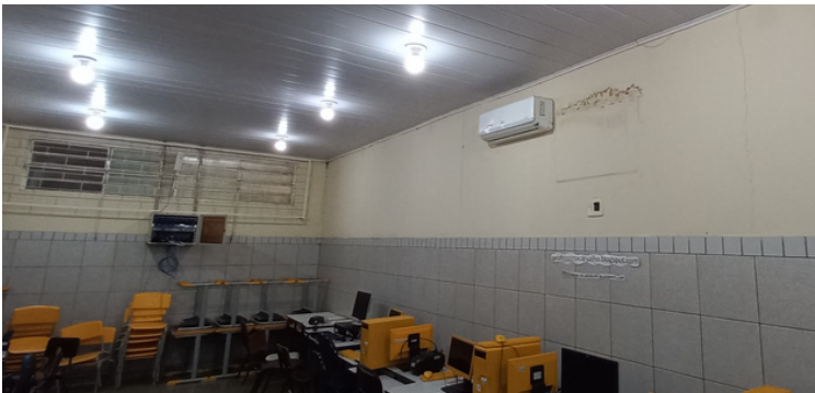
Foto 3 Sala de informática com frequente problema de infiltração.
