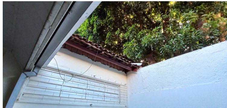
Foto 4 Árvore rente à escola causa constante danos devido à queda de frutas sobre o telhado.
