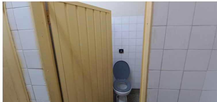
Foto 6 Banheiro ausente de manutenção na rede hidráulica.
