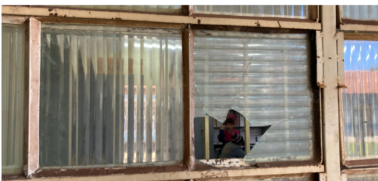
Foto 7 Vidros quebrados ou ausentes.
