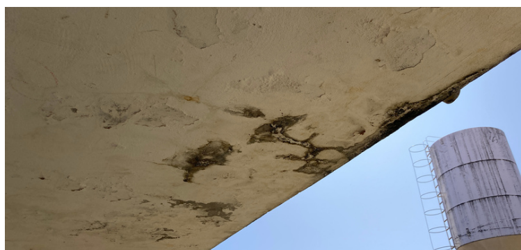
Foto 8 Infiltrações ocorrendo em locais pontuais da instituição.
