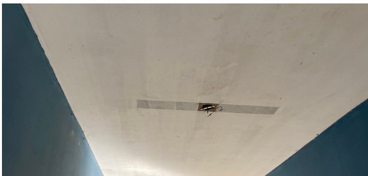
Foto 6 Iluminação necessitando de manutenção.
