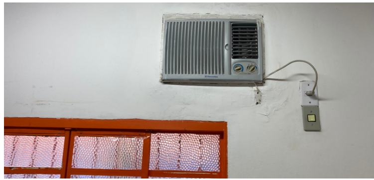
Foto 10 Ar-condicionado precisa de manutenção.
