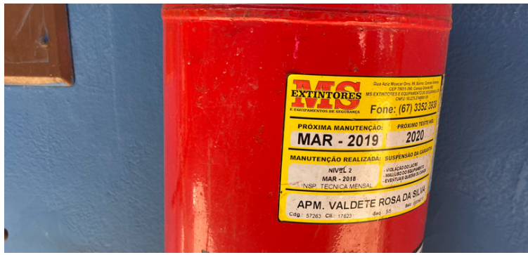
Foto 1 Extintores de incêndio vencidos desde março de 2019.
