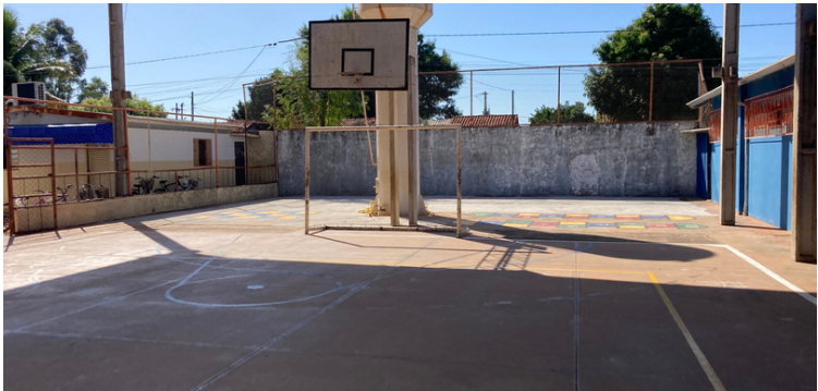
Foto 5 Quadra necessita de pintura.
