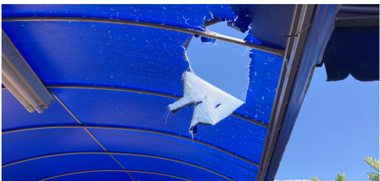
Foto 7 Toldo de cobertura no portão de saída dos alunos rasgado.
