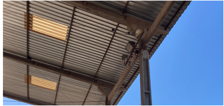
Foto 4 Pombos na estrutura da quadra de esportes.
