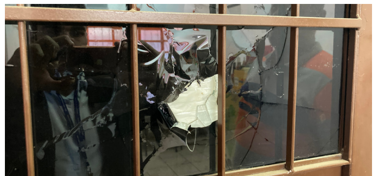
Foto 8 Vidro quebrado na porta da sala.
