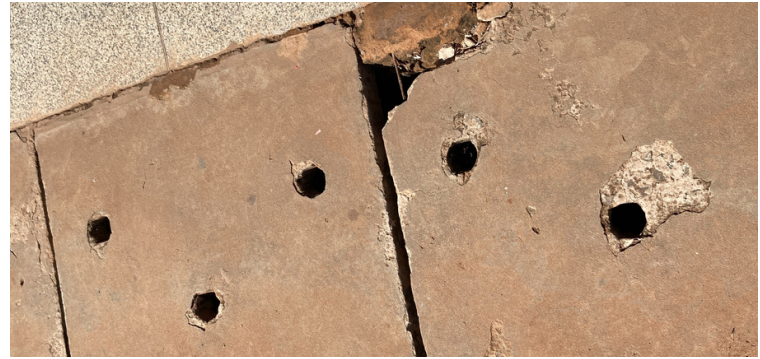
Foto 4 Tampas de proteção da vala para escoamento da água danificadas.
