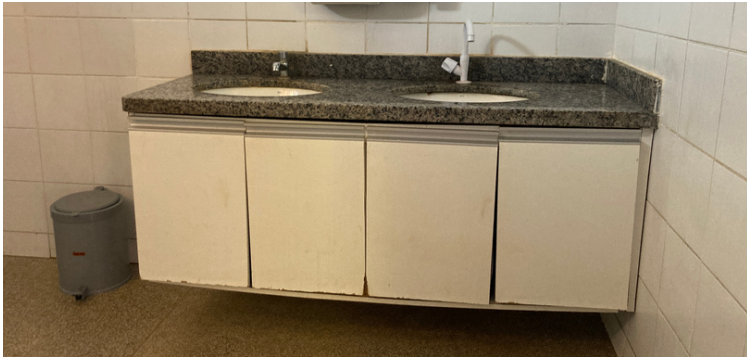
Foto 3 Armários novos já estão quebrados.
