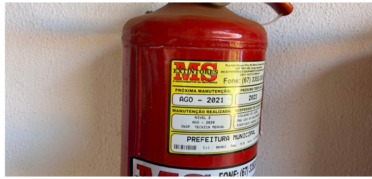
Foto 2 Extintor de incêndio vencido desde agosto de 2021.
