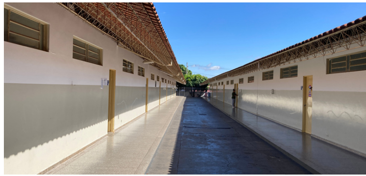
Foto 2 Corredores sem extintores de incêndio.
