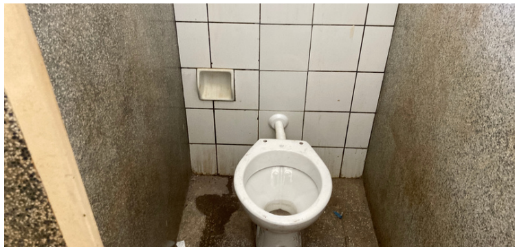
Foto 10 Falta de assento e tampa nos vasos sanitários.
