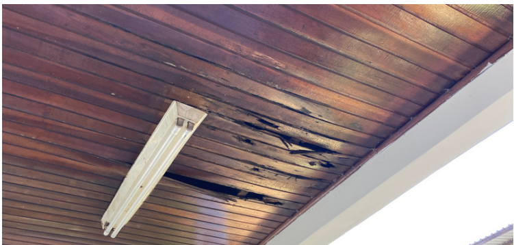
Foto 7 Forro de madeira danificado.
