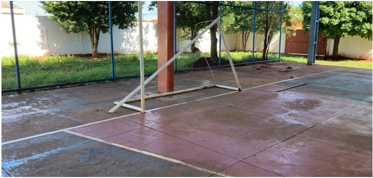
Foto 3 Trave na quadra de esportes quebrada.
