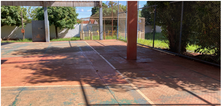
Foto 5 Pintura da quadra de esportes precisa de manutenção.
