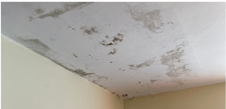
Foto 5 Infiltrações ocorrendo em determinados locais da escola.
