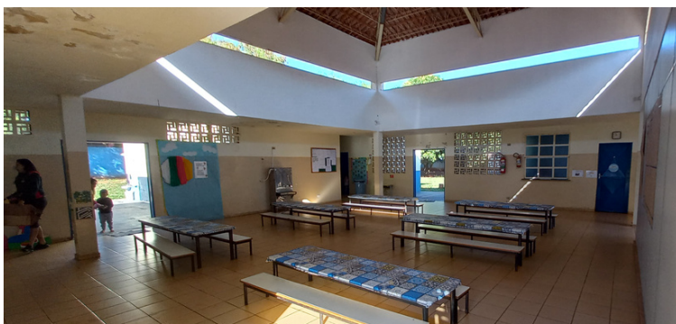
Foto 4 Refeitório amplo, higienizado e mobiliado, porém com manchas no teto, resquícios de infiltrações.
