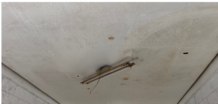
Foto 4 - Luminária antigas necessitando de manutenção.
