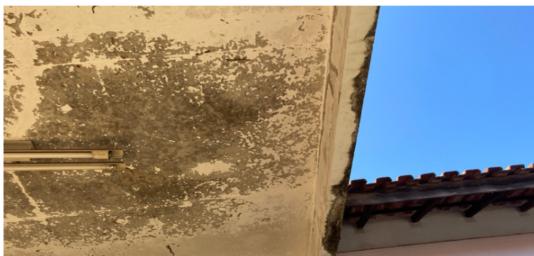
Foto 6 - Infiltrações encontradas em determinados locais da unidade.
