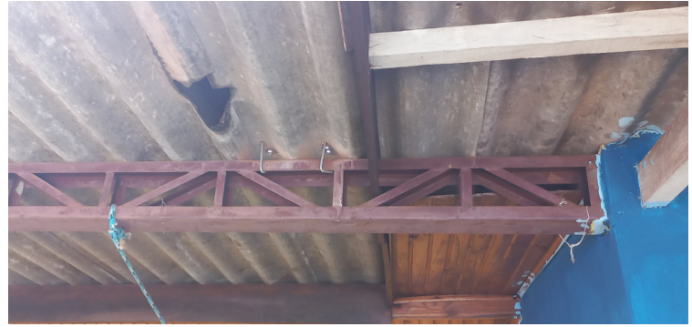
Foto 4 Telhas quebradas no pátio.
