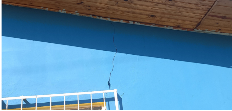
Foto 3 Parede com rachaduras.
