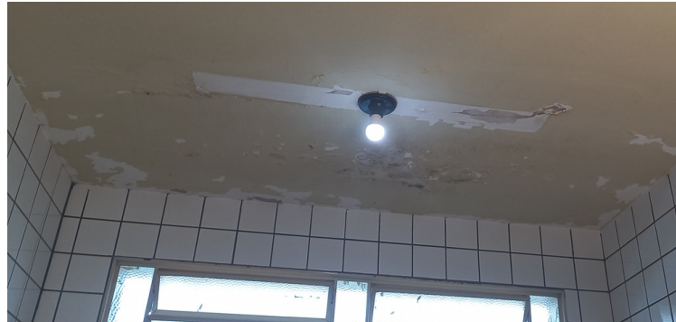
Foto 5 Laje do banheiro com problemas de infiltração.
