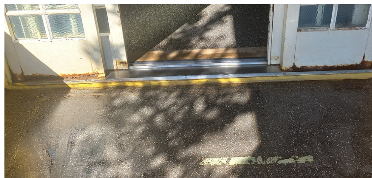
Foto 2 Porta de entrada com problemas de ferrugem.
