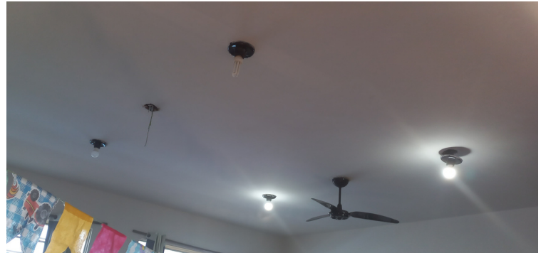
Foto 6 Sala de aula, lâmpadas com necessidade de serem trocadas.
