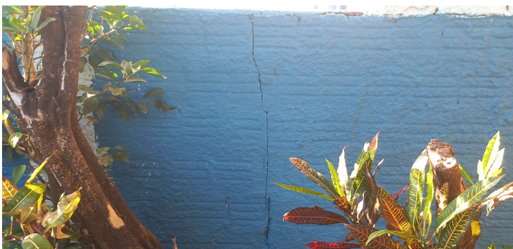
Foto 7 Muro com problemas de rachaduras na estrutura.
