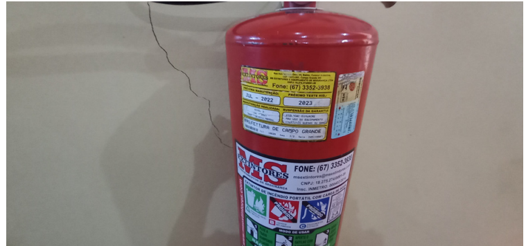
Foto 6 Extintor de incêndio dentro do prazo de validade.
