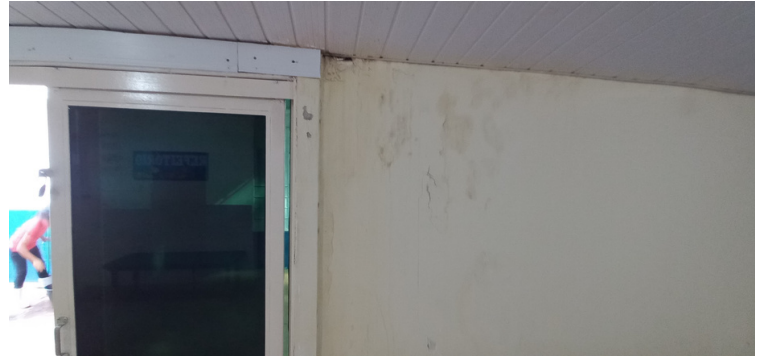
Foto 4 Paredes do refeitório com pontos de infiltrações.
