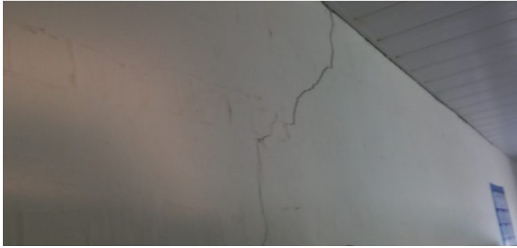
Foto 3 Paredes com rachaduras na estrutura.
