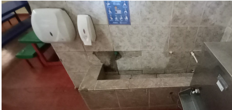
Foto 5 Torneira do lavatório com vazamento.
