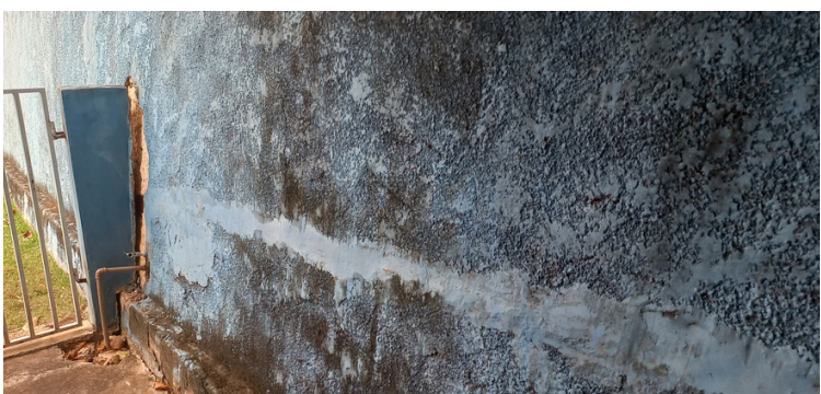
Foto 7 Rachadura consideravelmente extensa comprometendo a estrutura do muro.
