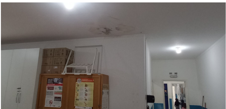
Foto 3 Resquícios de infiltrações ocorridas em determinados locais da escola.
