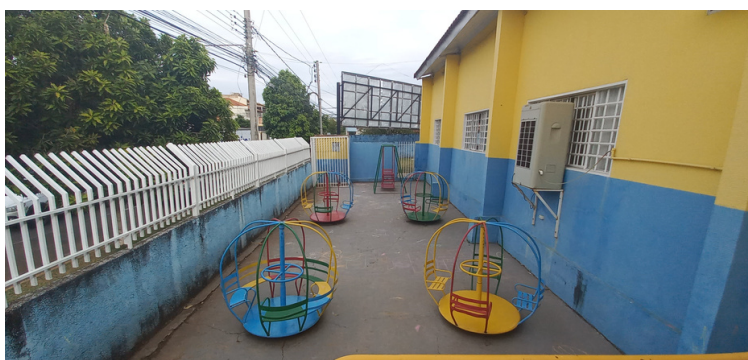
Foto 8 Parquinho necessitando de benfeitorias, como areia e brinquedos adequados para a faixa etária dos alunos da escola.
