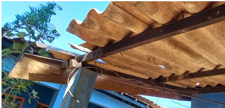
Foto 3 Telhado da lavanderia quebrado.
