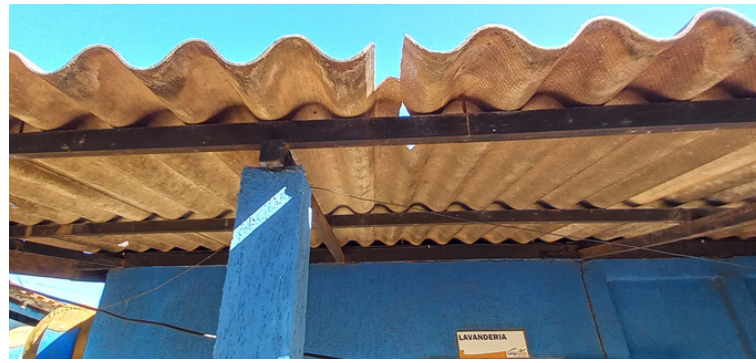
Foto 2 Telhas da lavanderia quebradas.
