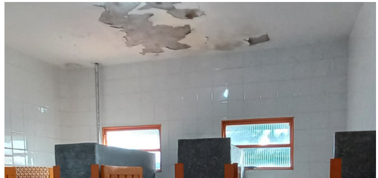
Foto 4 Laje do banheiro com infiltrações.
