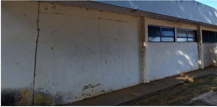
Foto 11 Paredes com rachaduras na estrutura.
