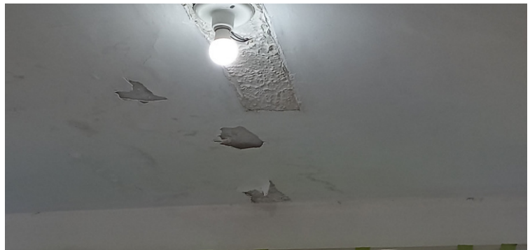
Foto 6 Teto da sala de aula com infiltrações.
