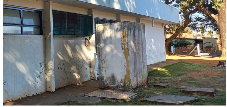
Foto 12 Paredes externa com infiltrações e mofo.
