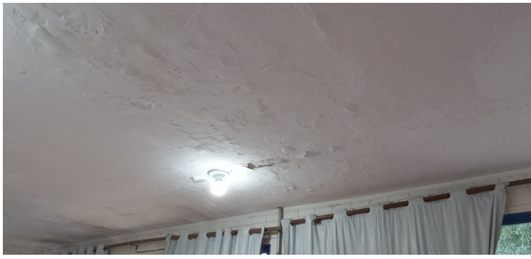
Foto 9 Teto da sala de aula 2 com infiltrações.
