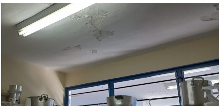
Foto 7 Teto da despensa com infiltrações.
