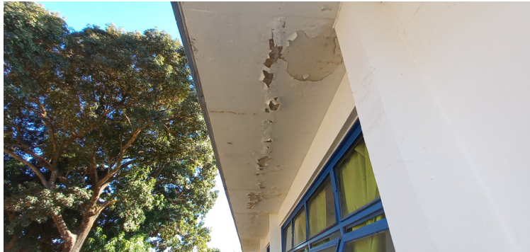
Foto 13 Teto da área externa com infiltrações.
