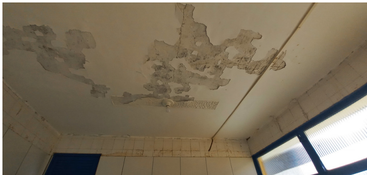
Foto 5 Teto do banheiro com infiltrações.
