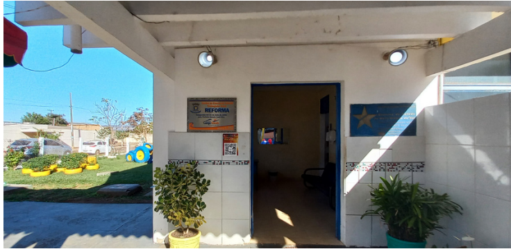
Foto 3 Recepção carece de pintura e solução das infiltrações.
