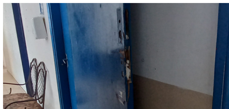
Foto 8 Porta da sala de aula quebrada
