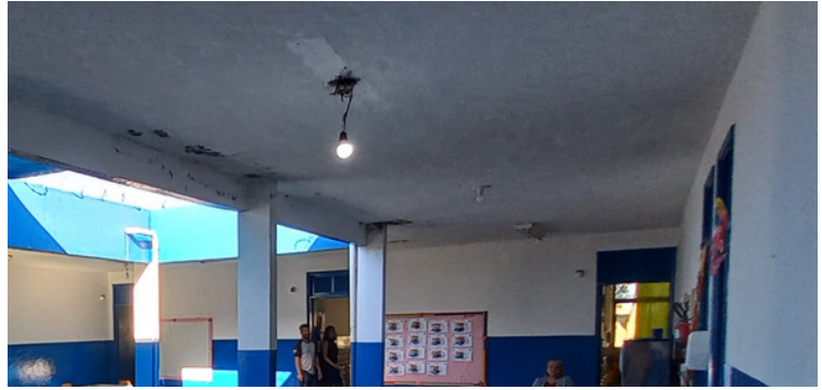
Foto 4 Refeitorio com problemas de infiltrações no teto.
