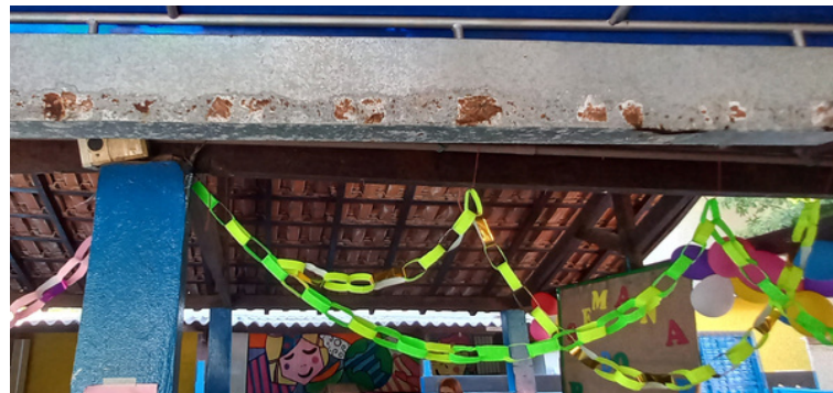
Foto 6 Calha do telhado enferrujada.
