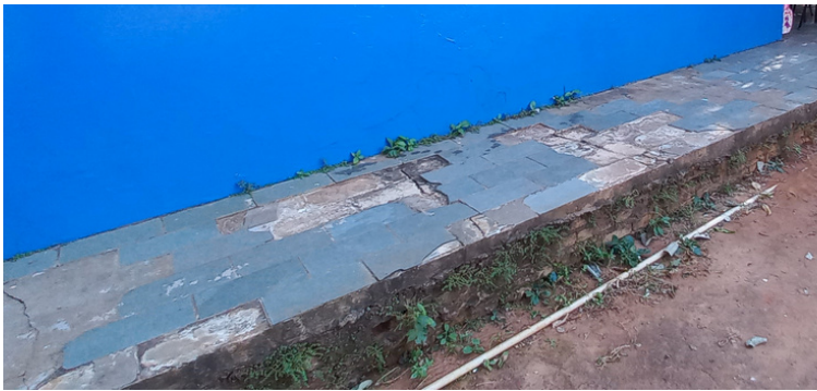
Foto 3 Calçada desgastada e sem rebaixamento.
