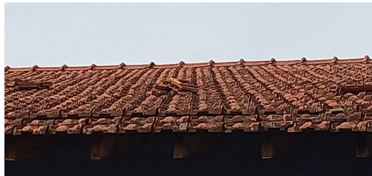
Foto 6 Telhado necessitando de reformas.
