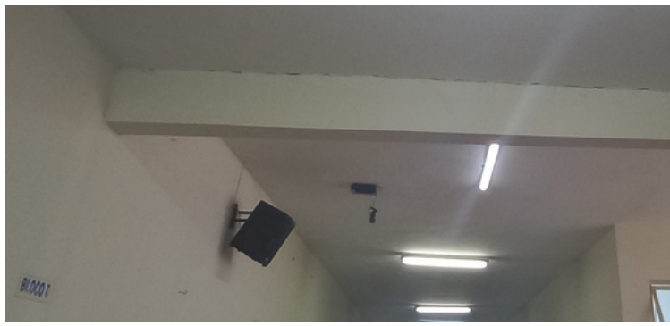
Foto 9 Vigas do teto com rachaduras.
