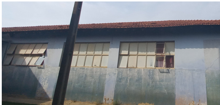
Foto 13 Pintura externa danificada.
