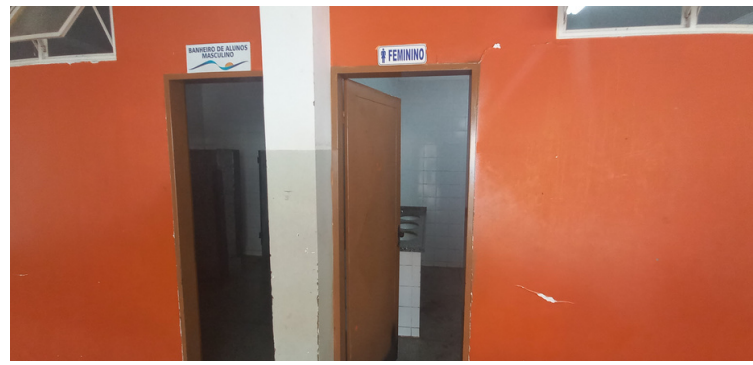
Foto 10 Banheiros necessitam de pintura e reformas.
