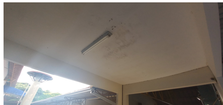
Foto 8 Teto do pátio com vários pontos de infiltrações.
