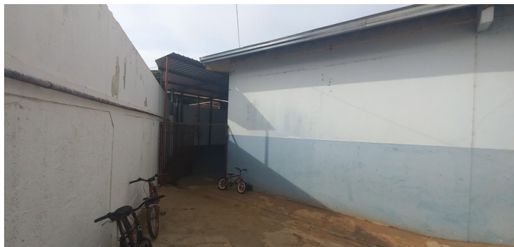
Foto 17 Necessidade de cobertura no corredor de entrada de alunos.
