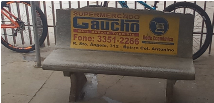
Foto 3 Banco do pátio da escola quebrado e com rachaduras.
