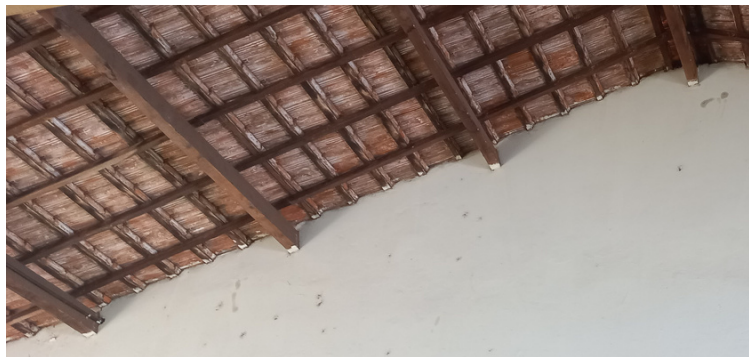
Foto 5 Telhado velho e com goteiras.
