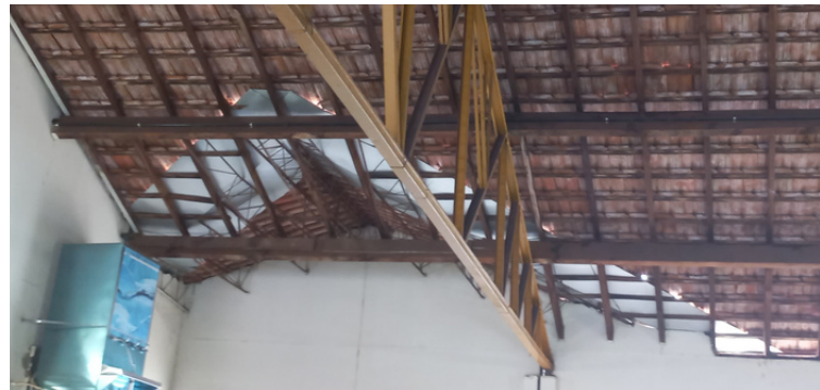
Foto 4 Telhado velho e com goteiras.
