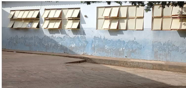
Foto 14 Pintura externa necessita de revitalização.
