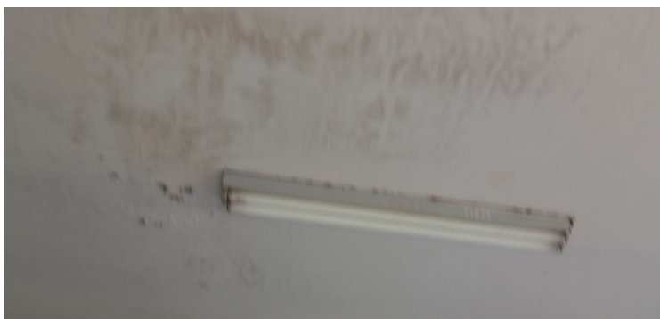
Foto 7 Teto com infiltrações.
