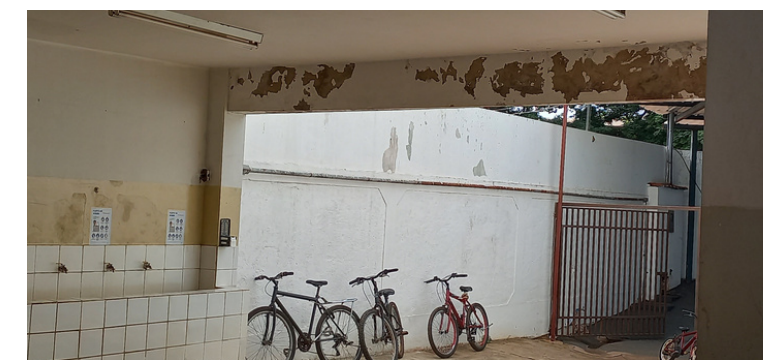
Foto 15 Pintura externa necessita de revitalização.
