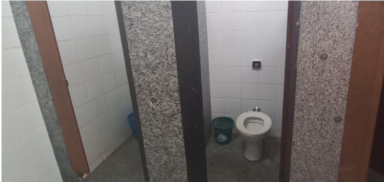
Foto 11 Banheiro necessita de reformas.
