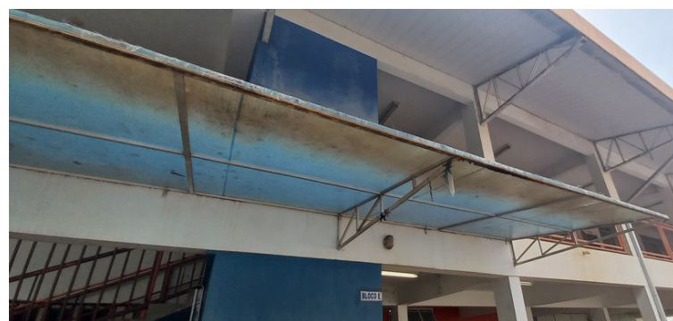
Foto 16 Toldo do pátio deteriorado.
