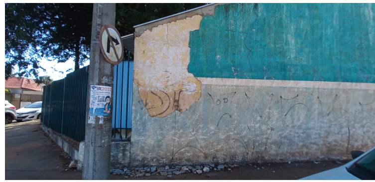
Foto 2 Muro da escola com reboco soltando em vários pontos.
