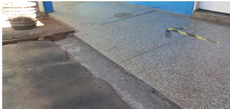
Foto 4 Piso do pátio com buracos.
