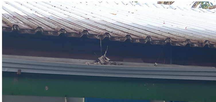
Foto 6 Calha instalada no teto do pátio entupida.
