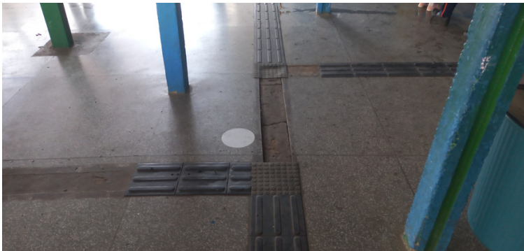
Foto 3 Piso do pátio com buracos.
