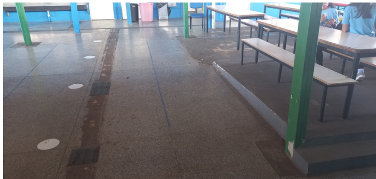
Foto 5 Piso do refeitório com buracos e desnível.
