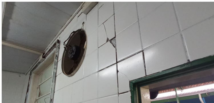
Foto 9 Exaustor da cozinha sem funcionar e revestimento soltando da parede.
