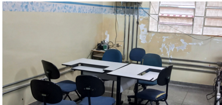
Foto 5 Sala necessita de pintura.
