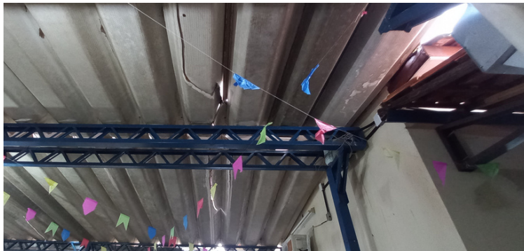
Foto 3 Telhado do pátio com varias telhas quebradas.
