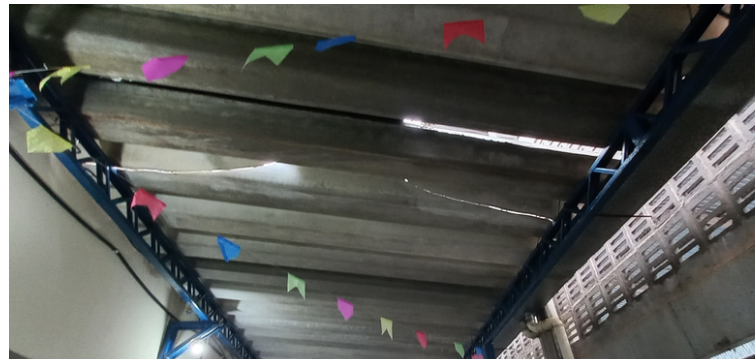
Foto 4 Telhado do pátio com varias telhas quebradas
