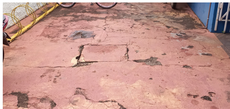
Foto 8 Calçada do pátio carece de reforma.
