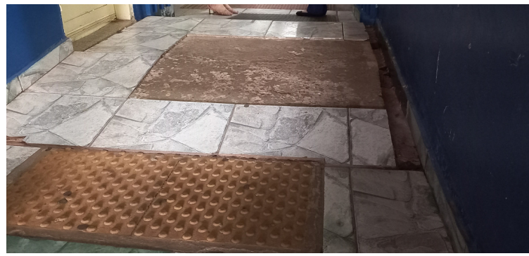
Foto 2 Piso com necessidade de reparos.
