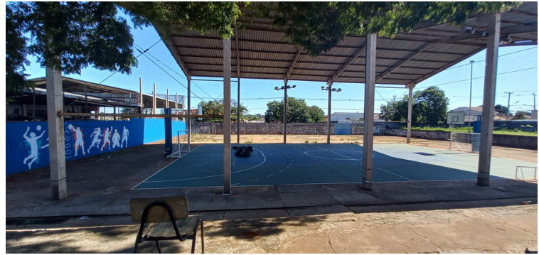
Foto 4 Quadra de esportes com necessidade de revitalização.
