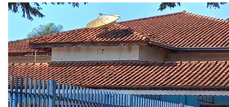
Foto 7 Telhado e fiação elétrica antigos, necessita de reparos constantes.
