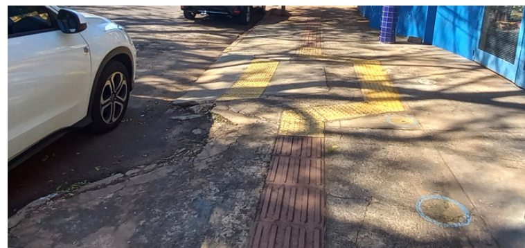
Foto 8 Calçada da entrada principal desgastada.
