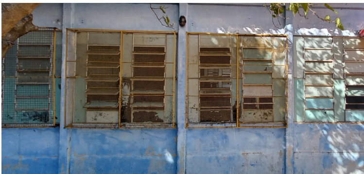
Foto 3 Janelas antigas e estragadas.
