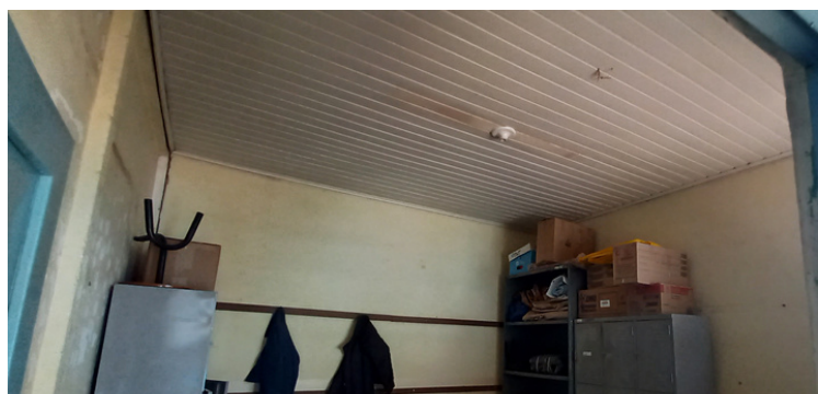
Foto 8 Sala de funcionários sem lâmpadas.
