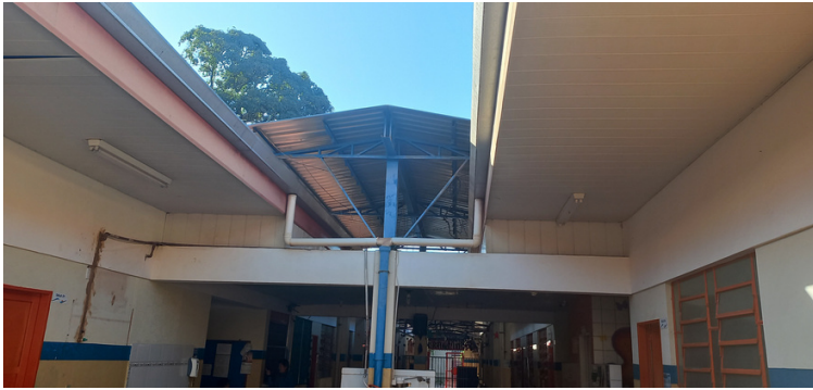
Foto 3 Calha ineficiente para vazão das águas das chuvas.
