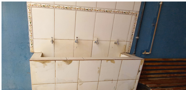
Foto 13 Lavatório inativo com vazamento.
