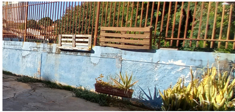
Foto 10 Muro com estrutura comprometida.
