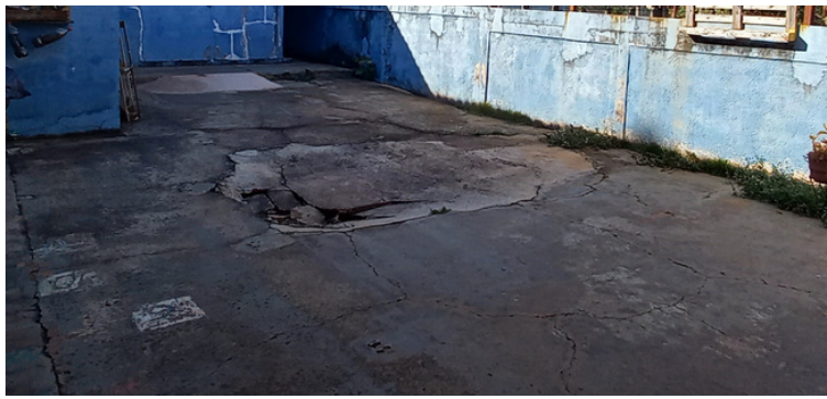
Foto 9 Buraco na calçada causado pela umidade do solo.
