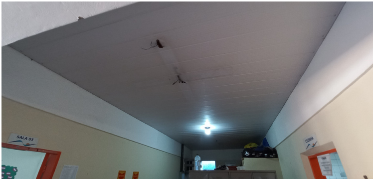
Foto 5 Corredores com falta de iluminação .
