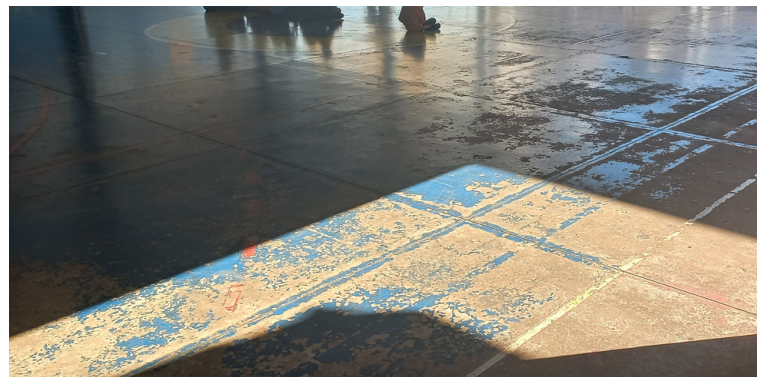
Foto 8 Quadra de esporte com pintura desgastada.
