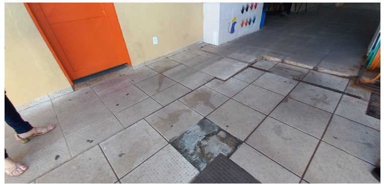
Foto 2 Piso quebrado, desnivelado e escorregadio.
