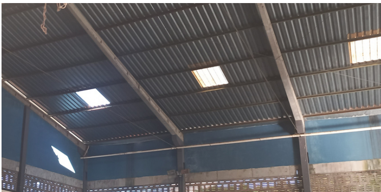
Foto 7 Cobertura da quadra de esporte com telhas faltando.
