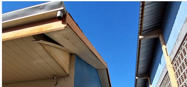
Foto 12 Forro solto e caindo.
