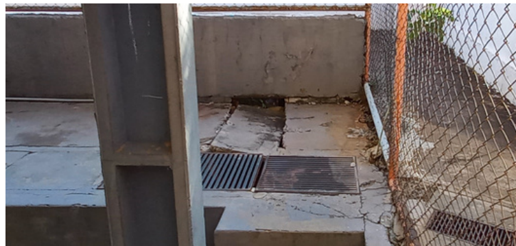
Foto 11 Tampa do ralo quebrada no pátio da escola.
