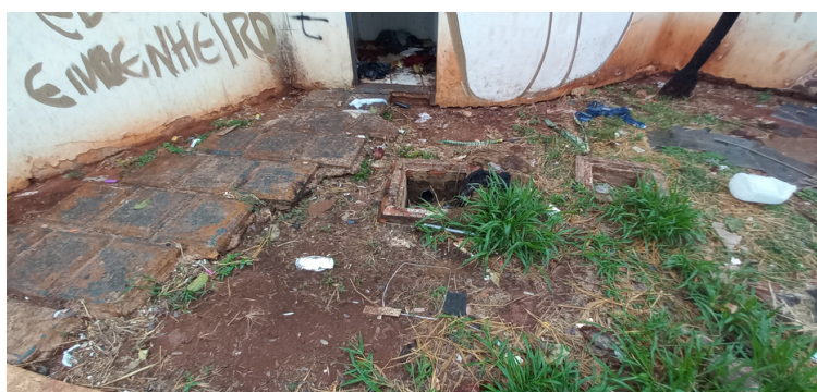
Foto 7 Praça sem manutenção com caixas de passagem abertas e calçamento todo deteriorado.
