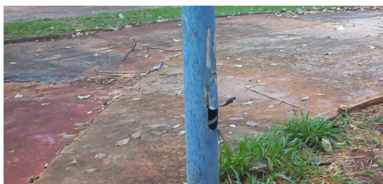
Foto 8 Postes com as tampas avariadas e fiação furtada.
