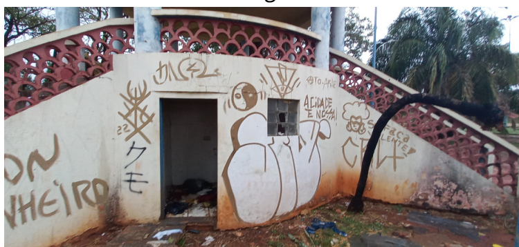
Foto 5 Faixadas dos banheiros todas vandalizadas, sujas e mofadas.
