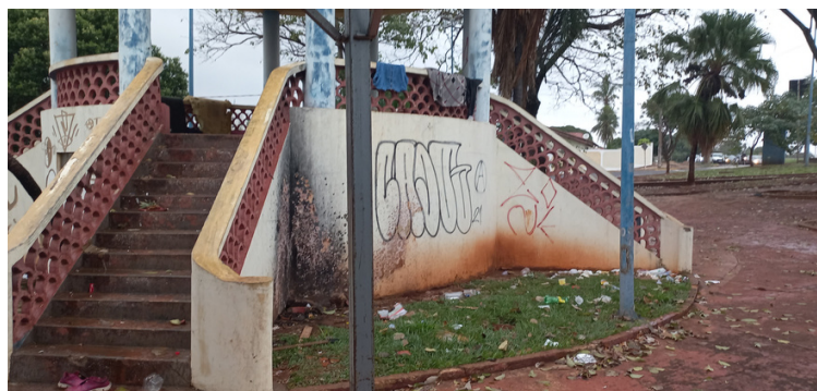
Foto 4 Coreto com a pintura completamente danificada por pichações e graves infiltrações.
