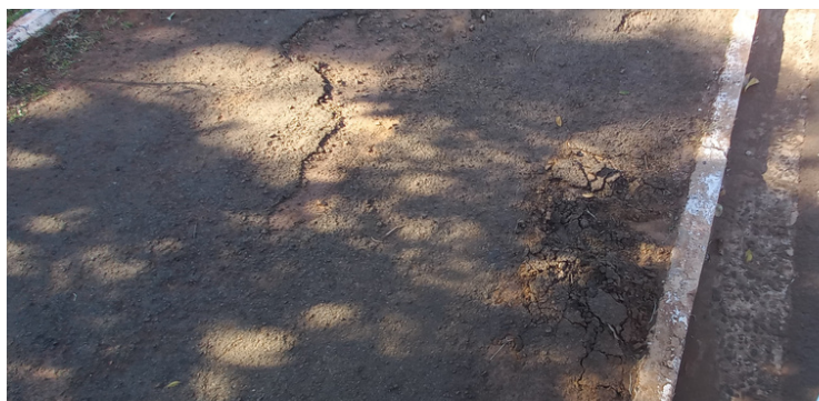
Foto 3 Pista de caminhada com muitos buracos em vários pontos.
