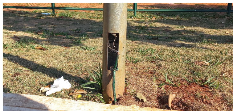
Foto 8 Fiação elétrica do poste de luz aparente.
