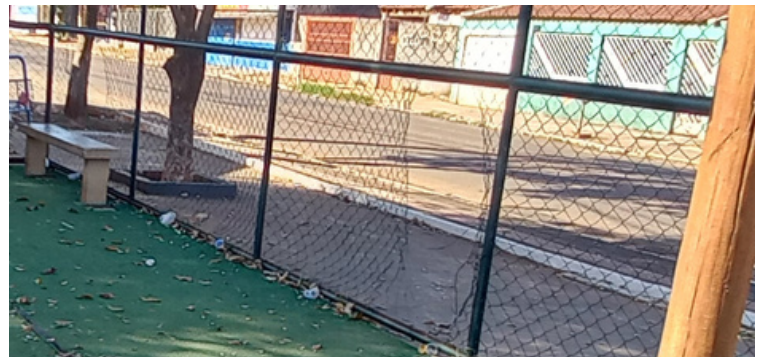
Foto 6 Grade de proteção do parque infantil com buracos na tela.
