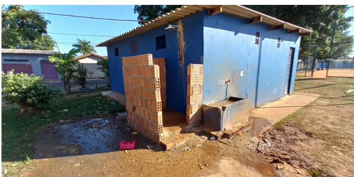
Foto 7 Necessidade de conclusão da obra de reforma do chuveirão.
