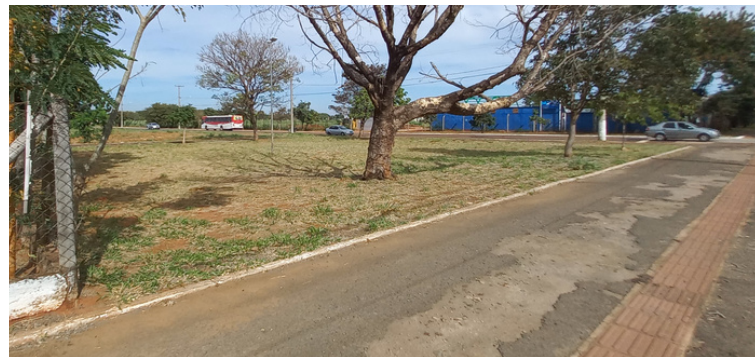
Foto 6 Pista de caminhada ao entorno da praça com extensas rachaduras.
