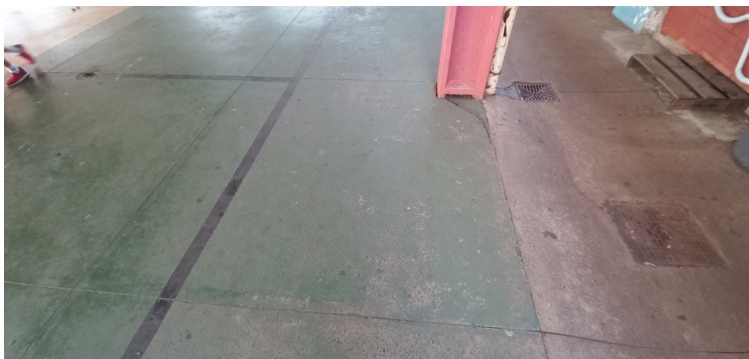
Foto 12 Piso da quadra com irregularidades por causa de buracos ou rachaduras.
