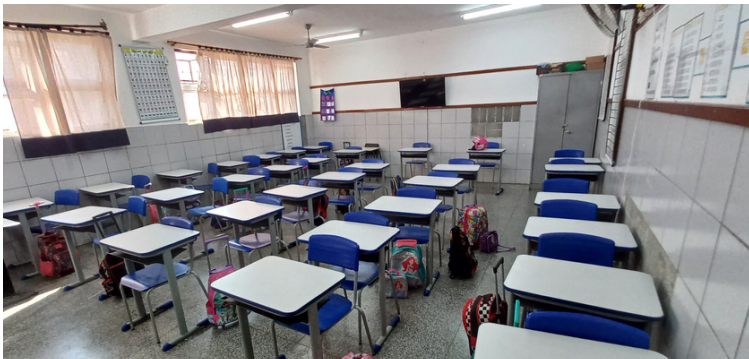
Foto 3 Salas de aulas devidamente mobiliadas e climatizadas, entretanto com o revestimento danificado.
