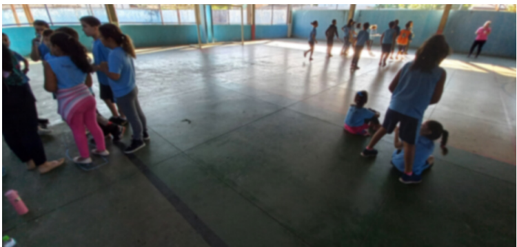
Foto 11 Quadra esportiva com a pintura desgastada.
