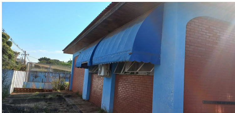
Foto 9 Toldos encontram-se danificados.
