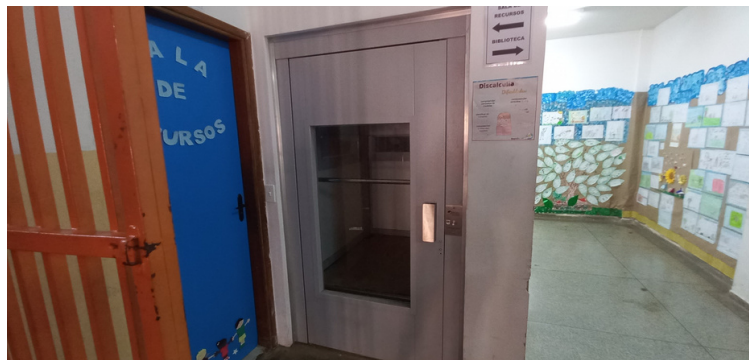
Foto 10 Elevador em desuso devido à falta de manutenção.
