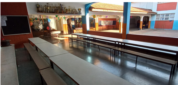
Foto 7 Determinados móveis do refeitório desgastados ou avariados.
