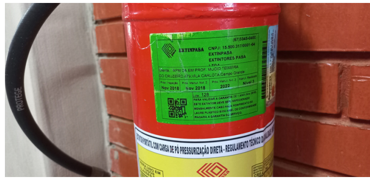
Foto 2 Extintores com a data de validade expirada.
