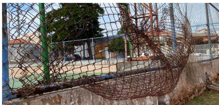
Foto 16 Grade de proteção danificada.
