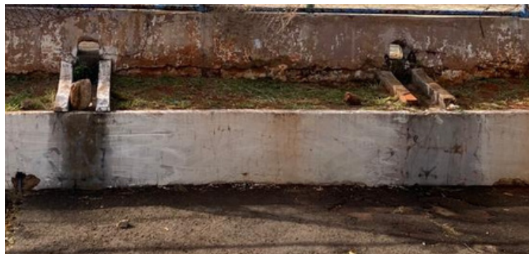
Foto 18 Ralo de drenagem sem tampa.
