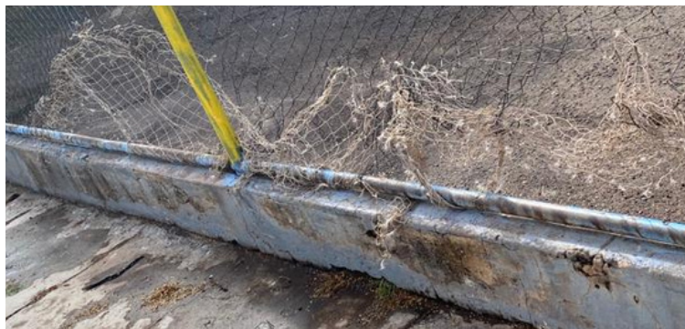
Foto 17 Grade de Proteção com remendos.
