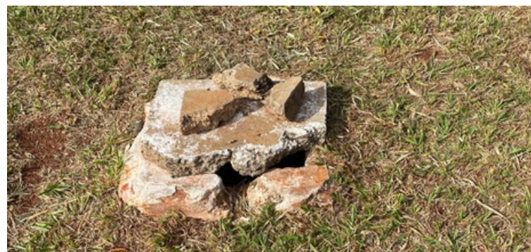
Foto 8 Tampa da caixa de esgoto quebrada.
