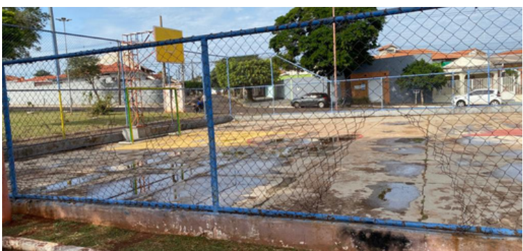
Foto 15 Grade de proteção cortada.
