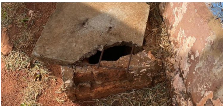
Foto 7 Tampa da caixa de esgoto quebrada.
