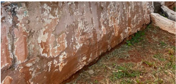
Foto 19 Muro da quadra com infiltrações.
