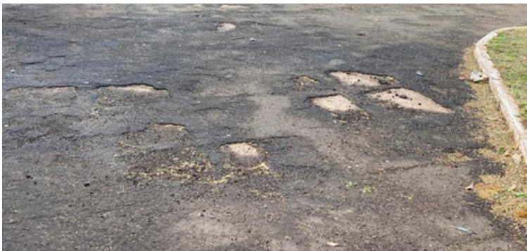
Foto 5 Pátio da praça com a calçada danificada.
