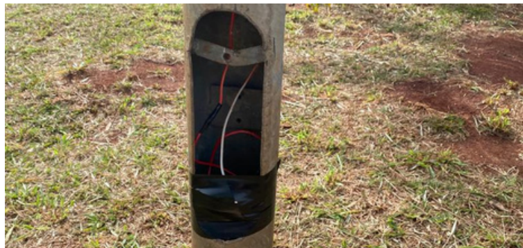
Foto 6 Fiação elétrica aparente.
