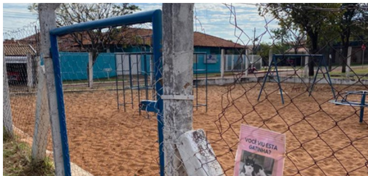
Foto 9 Portão do Parque infantil avariado.
