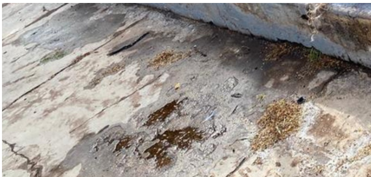
Foto 20 Piso da quadra com infiltrações em vários pontos.
