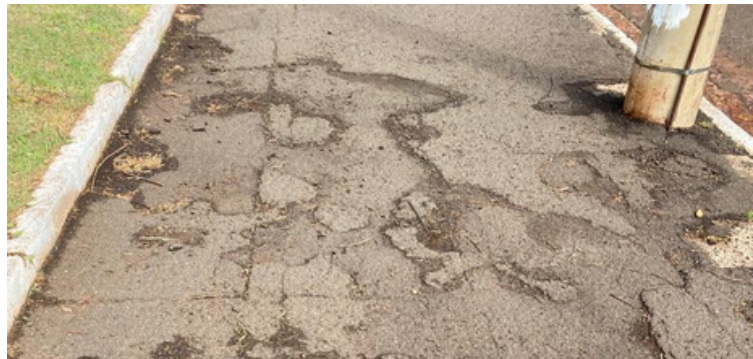
Foto 4 Vários pontos defeituosos na pista de caminhada.
