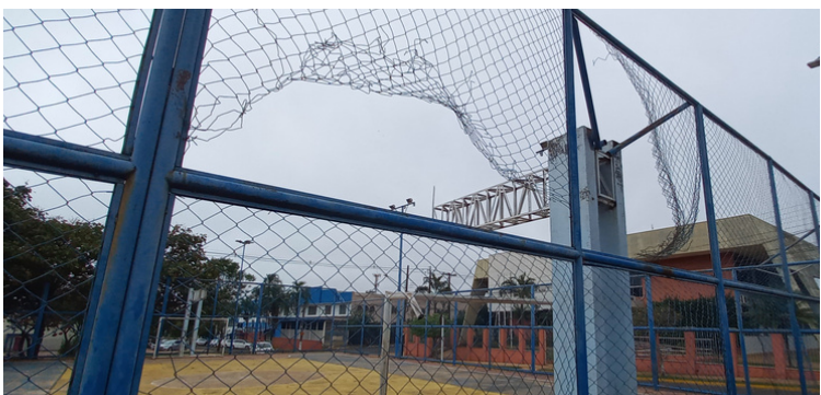
Foto 11 Grade de proteção danificada.
