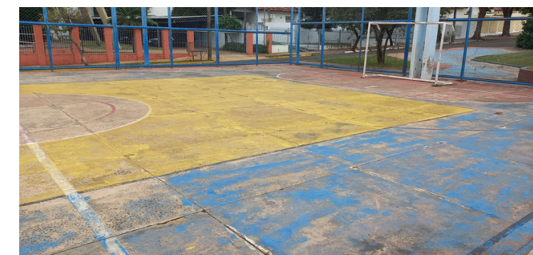
Foto 15 Pintura da quadra necessita de revitalização.
