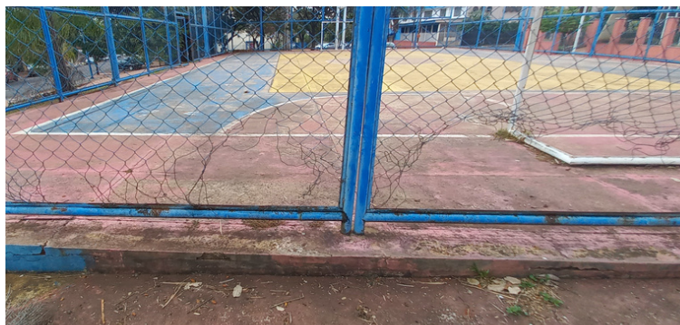
Foto 13 Grade de proteção aberta.
