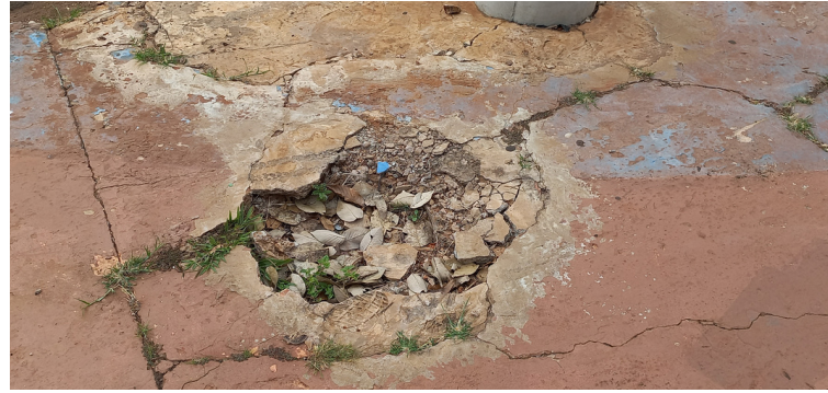
Foto 4 Calçada com buracos.
