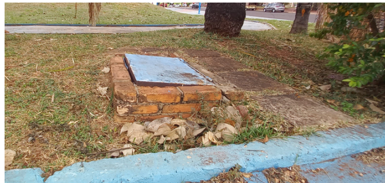
Foto 6 Caixa de esgoto quebrada.
