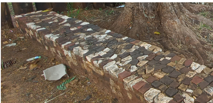
Foto 7 Falta de limpeza em vários pontos.
