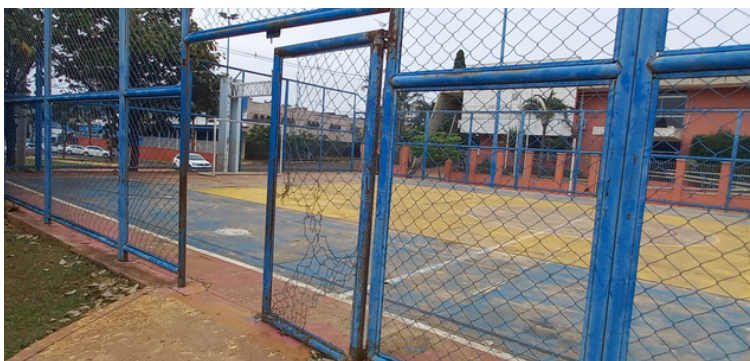
Foto 12 Portão da quadra de esporte depredado.
