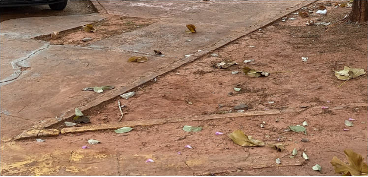
Foto 3 Calçada com buracos .
