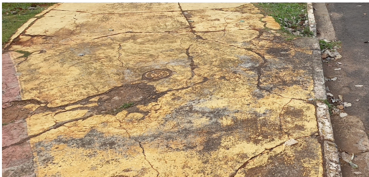
Foto 5 Calçamento com rachaduras.
