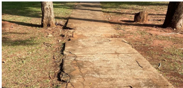
Foto 2 Pista de caminhada com rachaduras.
