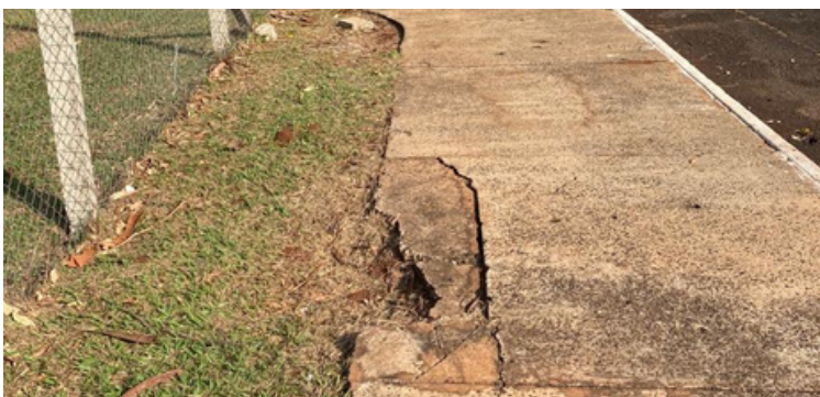
Foto 3 Pista de caminhada com rachaduras.
