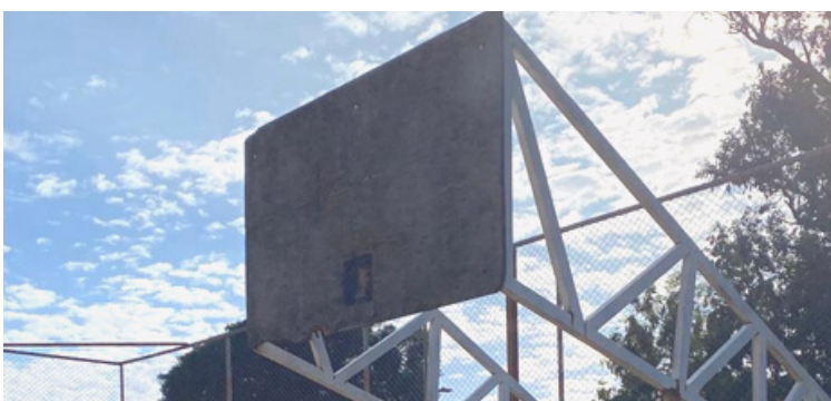
Foto 7 Tabela de basquete deteriorada.
