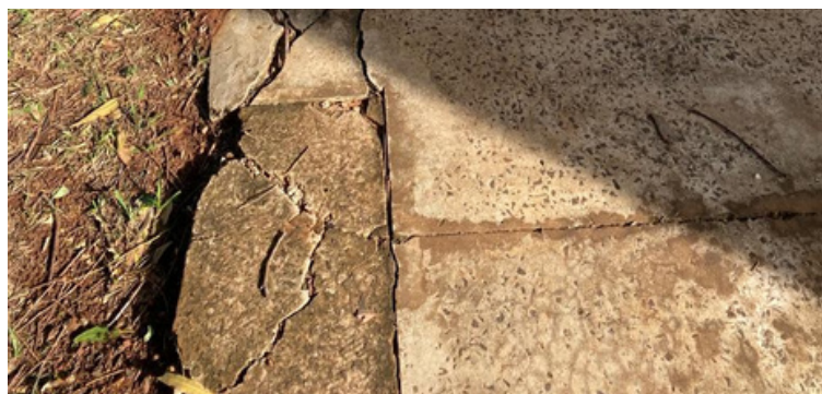
Foto 4 Pista de caminhada com desnível e rachaduras.
