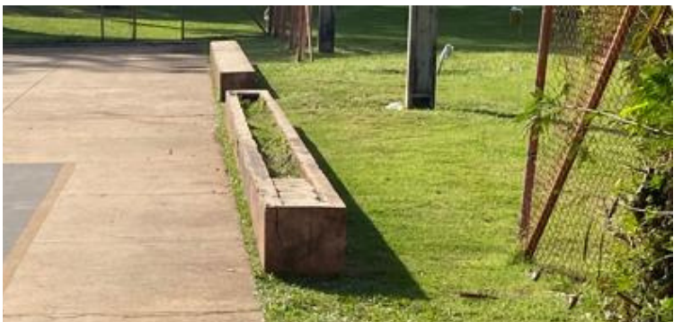
Foto 11 Grade de proteção da quadra faltando.
