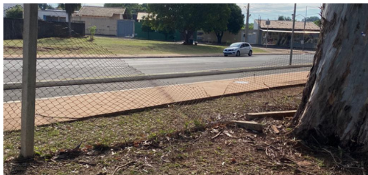
Foto 6 Grade de arame rompida.
