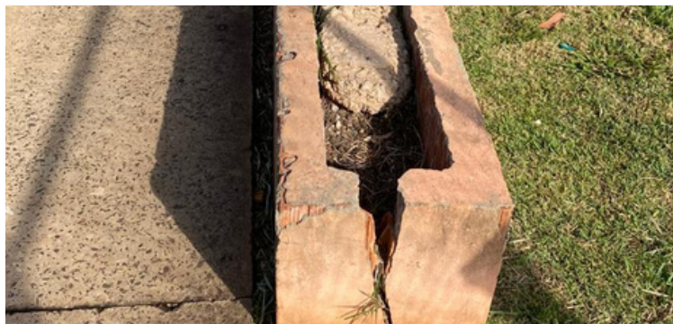
Foto 10 Bancos da quadra de esportes quebrados.
