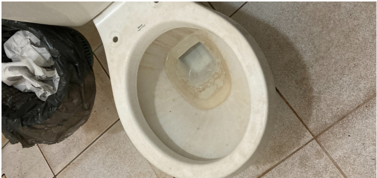
Foto 13 Vaso sanitário do camarim sem assento e tampa.
