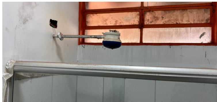
Foto 16 Chuveiro do banheiro com vazamento constante.
