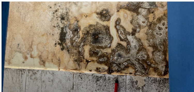
Foto 15 Infiltração com mofo na parede do segundo camarim.
