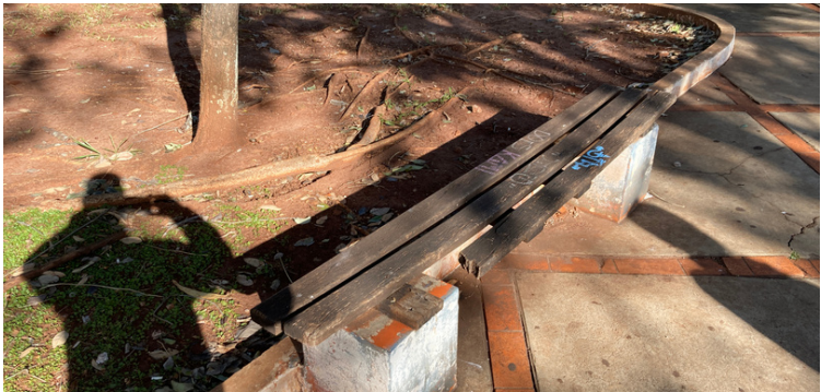
Foto 5 Bancos de repouso com o assento de madeira quebrado.
