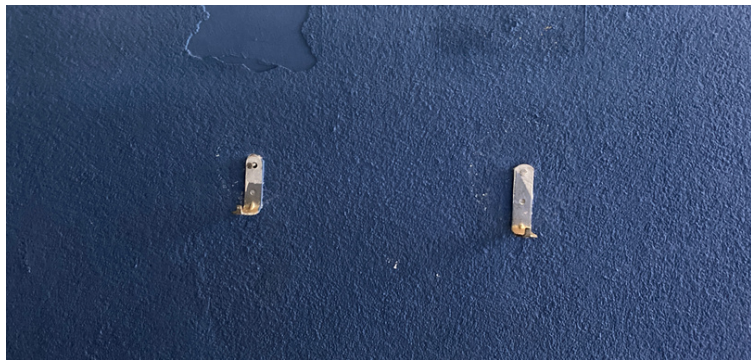
Foto 17 Falta de extintores nos suportes.
