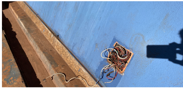
Foto 10 Fiação elétrica da tomada localizada no palco sem a devida proteção.
