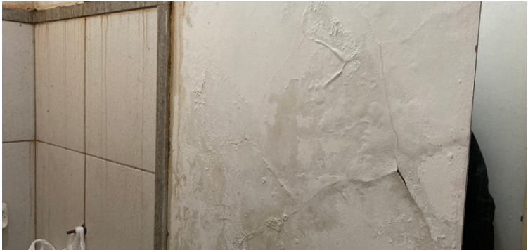
Foto 11 Infiltração na parede do camarim.
