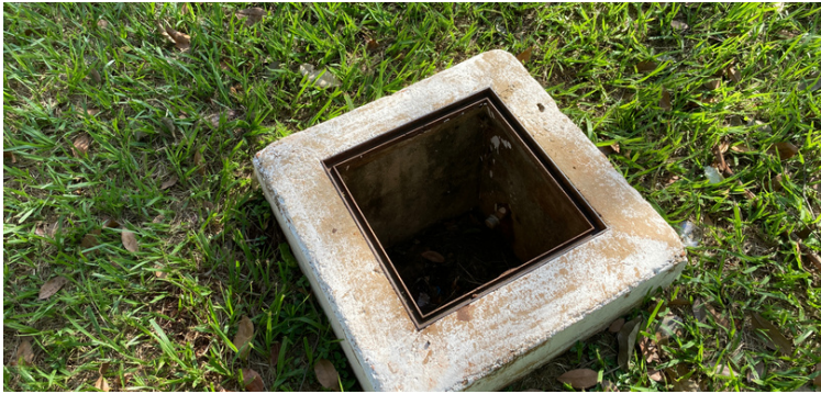
Foto 19 Caixa de energia sem tampa.
