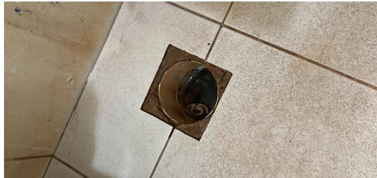
Foto 14 Ralo do banheiro sem proteção.
