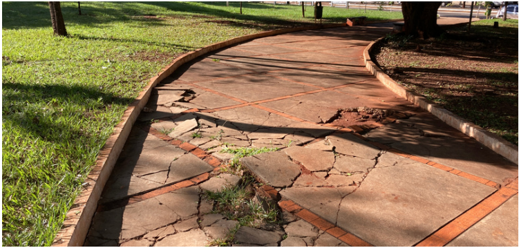
Foto 3 Calçamento danificado próximo à concha acústica.
