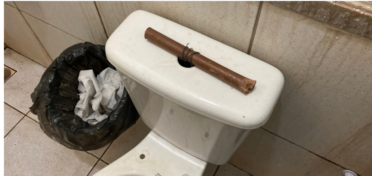
Foto 12 Descarga do vaso sanitário do camarim danificada.
