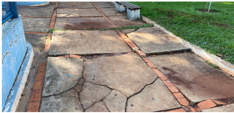
Foto 1 Desnível na pista de caminhada em frente ao parquinho e academia ao ar livre.
