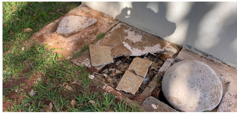
Foto 18 Tampas das caixas de esgoto quebradas.
