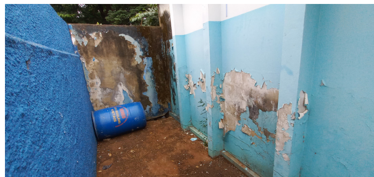
Foto 8 Muro evidentemente comprometido.
