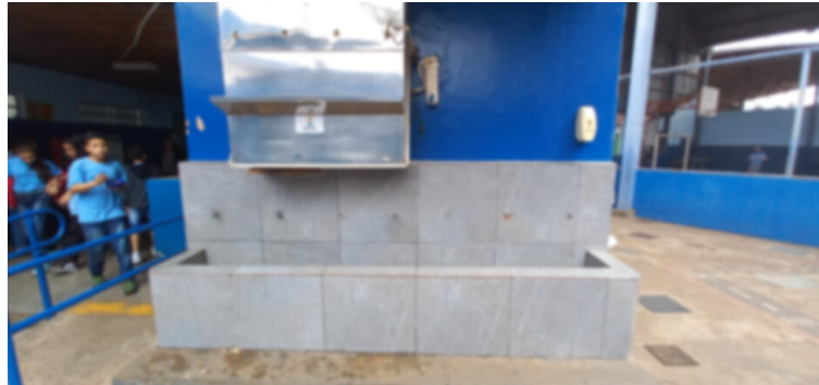
Foto 6 Bebedouros sem torneiras e depredados.
