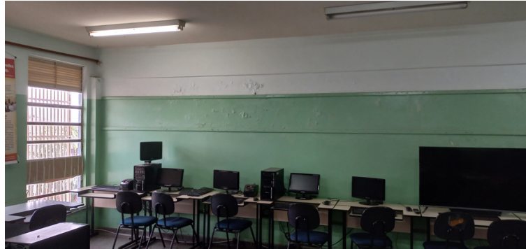
Foto 4 Infiltrações ocorrendo em locais pontuais da instituição.
