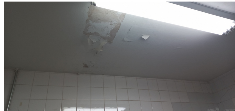
Foto 6 Infiltrações ocorrendo em determinados locais da unidade.
