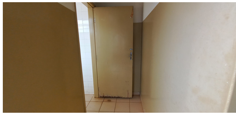
Foto 2 Portas, em sua maioria, encontram-se consideravelmente deterioradas.
