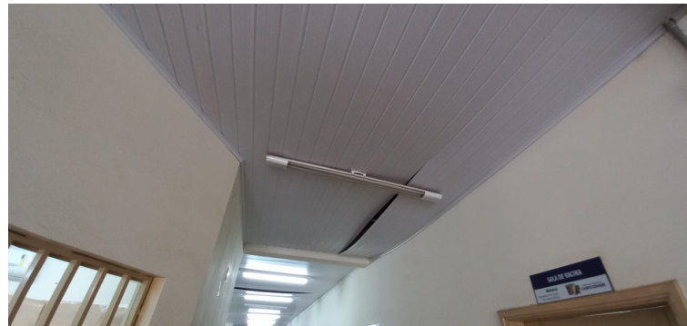
Foto 4 Estrutura da cobertura de forro deformada em determinados locais.
