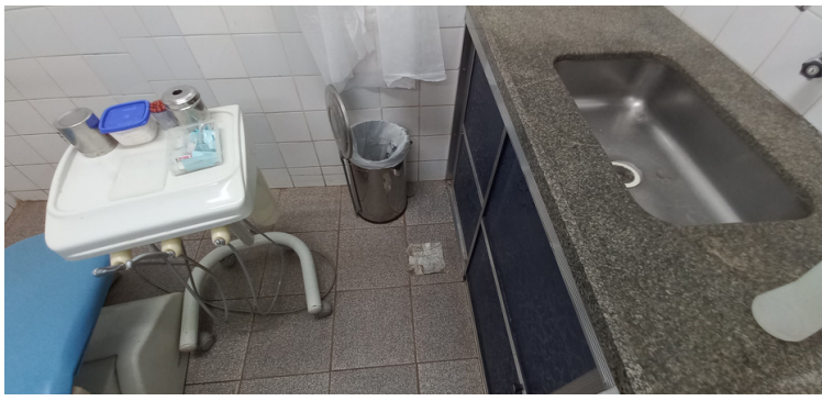
Foto 9 Ralos dispostos nas dependências da unidade, encontram-se sem as tampas.
