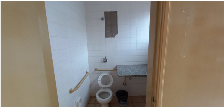
Foto 3 Banheiros apresentam-se avariados.
