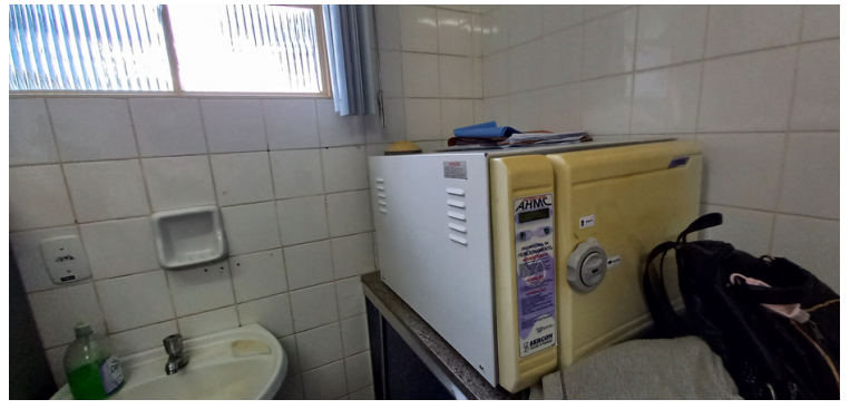
Foto 10 Autoclave danificada prejudicando a rotina de atendimentos.
