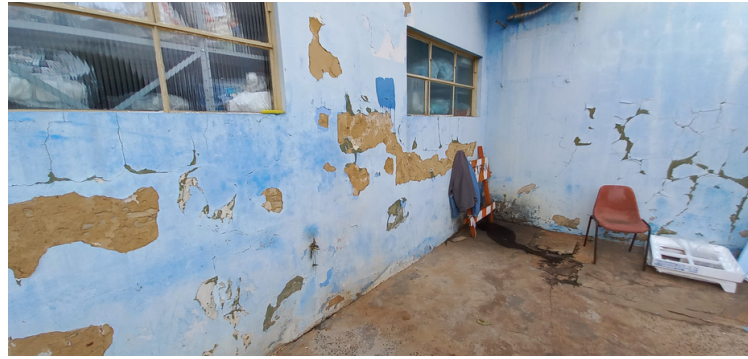
Foto 11 Pintura consideravelmente desgastada por toda a extensão da unidade.
