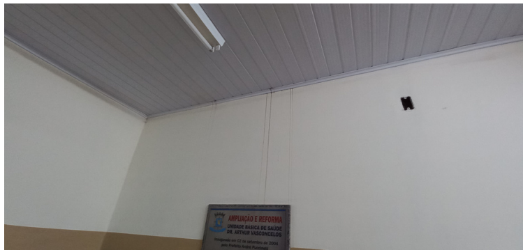
Foto 5 Deficiência na instalação do teto, acarreta no vazamento de águas pluviais.
