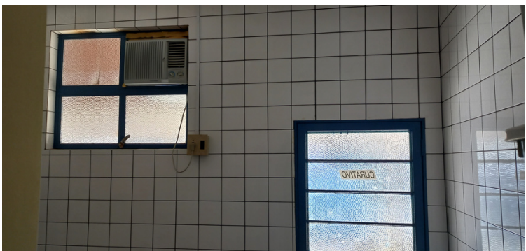
Foto 3 Ar condicionados obsoletos, ineficazes
