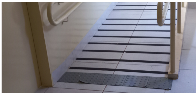
Foto 5 Rampa de acesso à sala de odontologia avariada.
