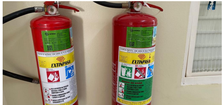
Foto 12 Extintores de incêndio fora do prazo de validade.
