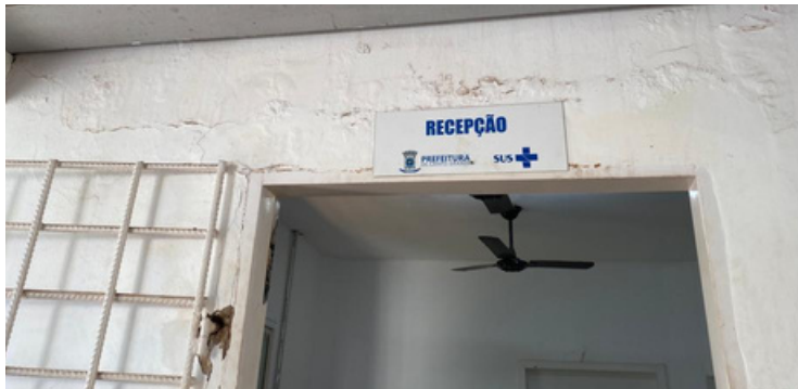
Foto 3 Parede externa da recepção estrutura comprometida e com infiltrações.
