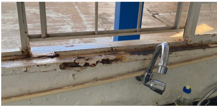
Foto 09 Janela da copa deteriorada e com ferrugens.
