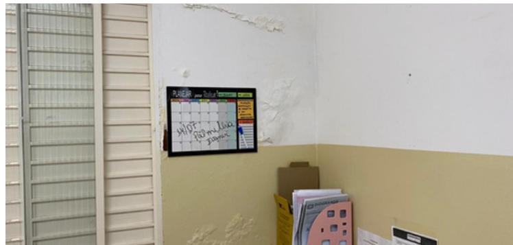
Foto 5 Consultório médico 1 com infiltrações nas paredes.
