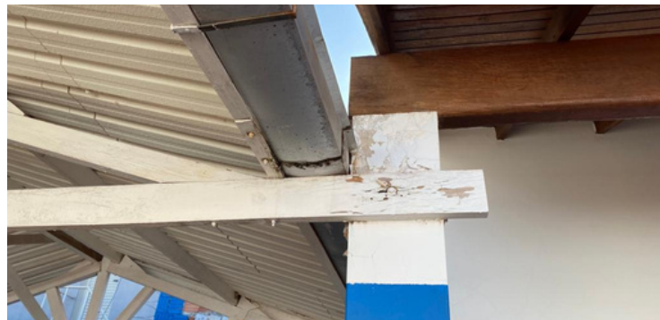
Foto 13 Telhado com problemas na estrutura.
