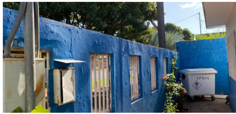
Foto 2 Muro Frontal da unidade com estrutura comprometida.
