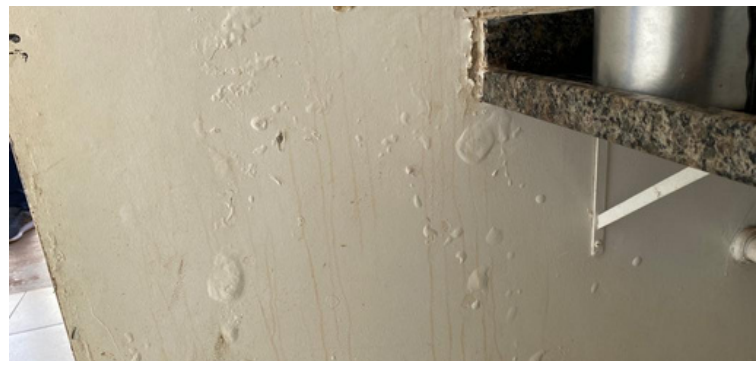
Foto 10 Paredes internas da copa com infiltrações.
