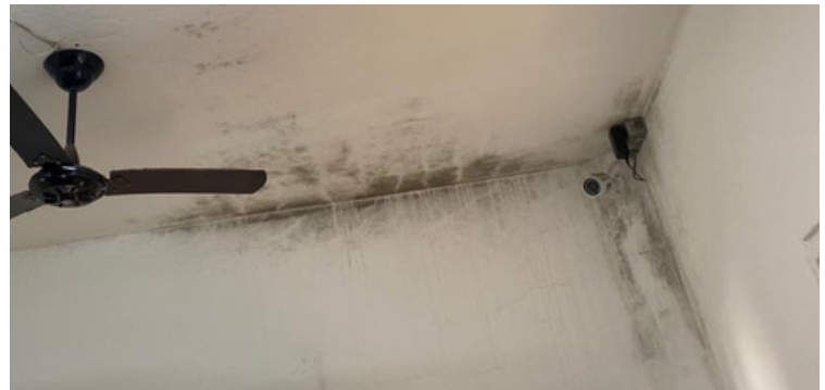
Foto 4 Parede interna da recepção com mofo e infiltrações.
