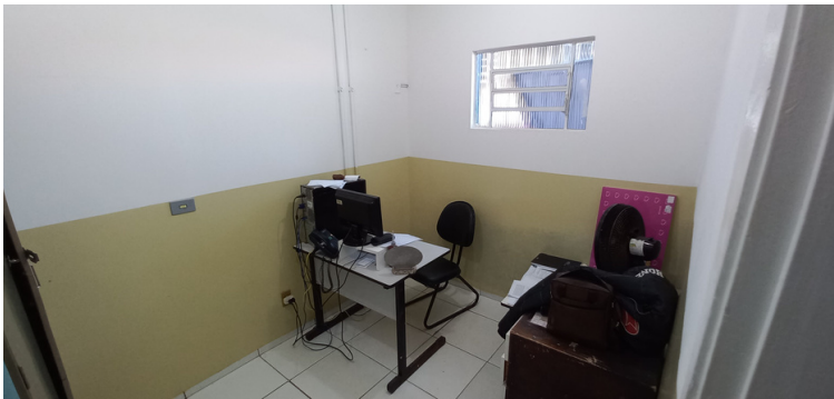
Foto 3 Determinados consultórios sem a devida climatização.
