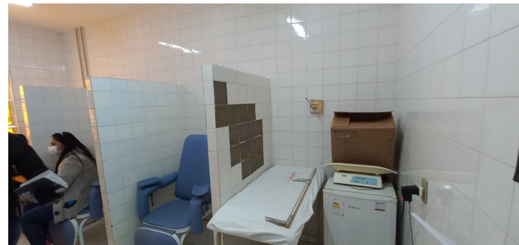
Foto 6 Consultório com revestimento danificado.
